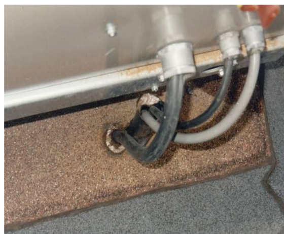
Obr. 25: Chybně vyřešený detail Zdroj: osobní archiv Káně L.
