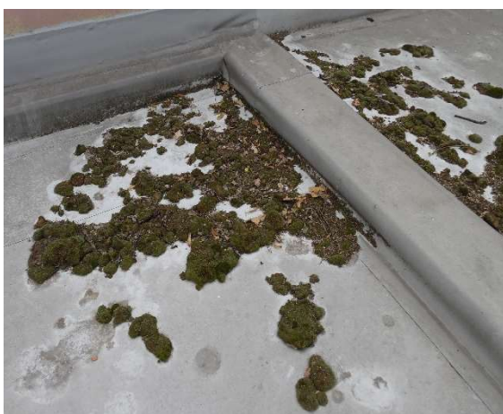
Obr. 29: Nedostatečná údržba Zdroj: osobní archiv Káně L.
