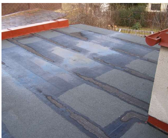
Obr. 16: Chybné provedení asfalt. pásů – překrytí spojů asfaltem Zdroj: osobní archiv Káně L.
