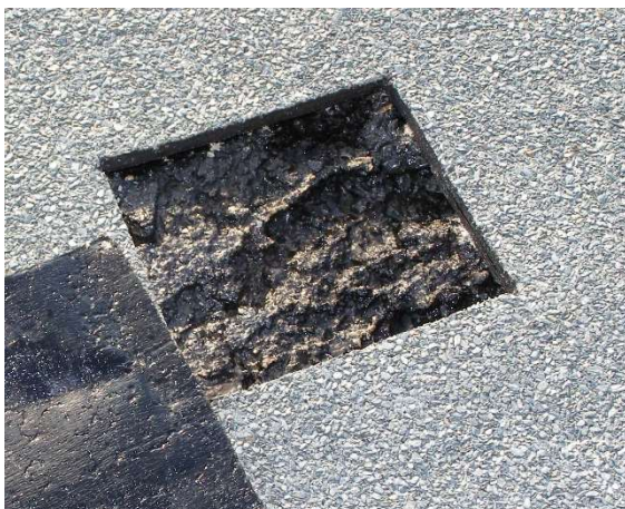
Obr. 18: Chybné provedení asfalt. pasů – nerovný podklad Zdroj: osobní archiv Káně L.
