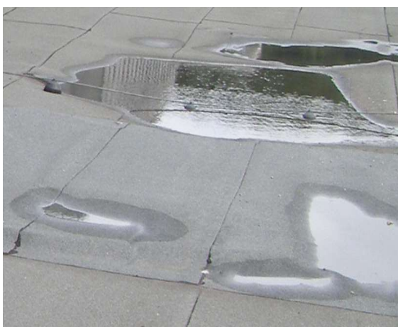
Obr. 11: Kulturní dům v Ústí – kaluže vody Zdroj: osobní archiv L. Káně
