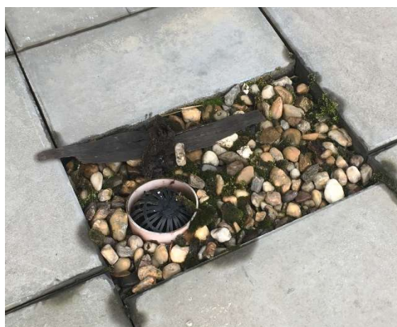
Obr. 28: Nedostatečná údržba – gule Zdroj: vlastní
