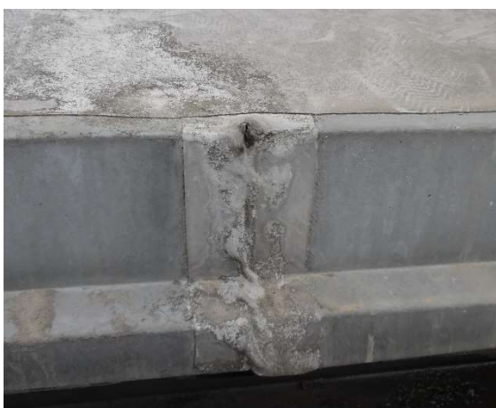
Obr. 24: Chybně provedeno překrytí dilatace Zdroj: osobní archiv Káně L.
