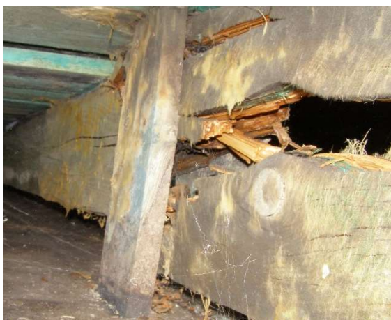
Obr. 14: Kulturní dům v Ústí – zborcený trám Zdroj: osobní archiv Káně L.
