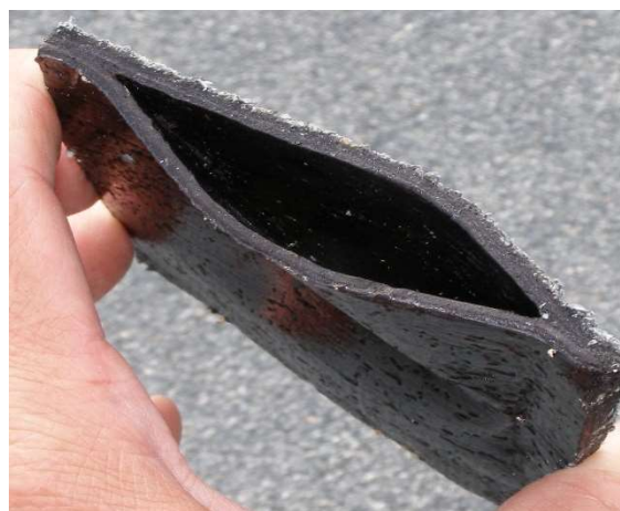
Obr. 15: Chybné provedení asfalt. pásů – nespojení vrstev pásů Zdroj: osobní archiv Káně L.
