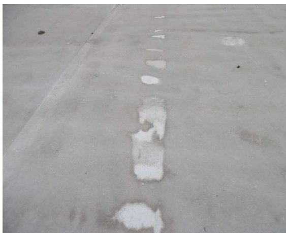
Obr. 23: Posun separační vrstvy pod hydroizolací Zdroj: osobní archiv Káně L.
