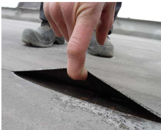
Obr. 22: Chybně provedený spoj Zdroj: osobní archiv Káně L.
