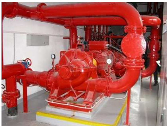
Obrázek č. 15 – Čerpací zařízení s elektromotorem
