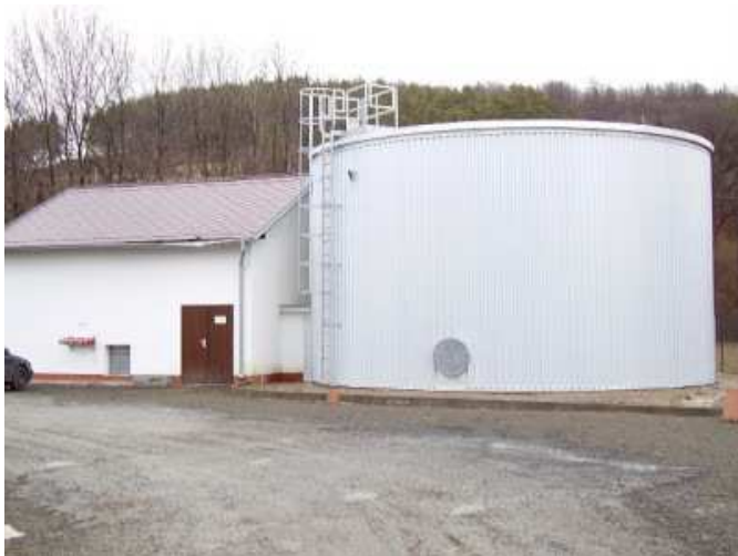
Obrázek č. 7 – Venkovní strojovna SHZ se zásobní nádrží [14]
