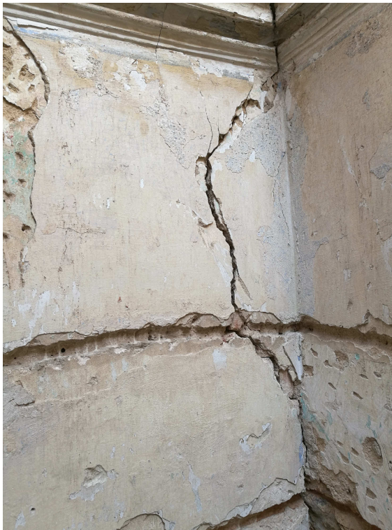
Obr. 7 rozsáhlá trhлина T21i ve vnitřní zdi
