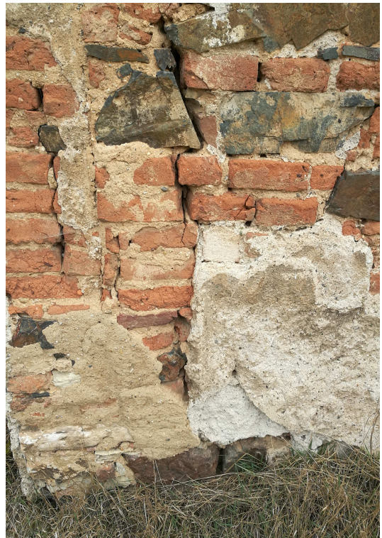
Obr. 9 špatná vazba zdiva
