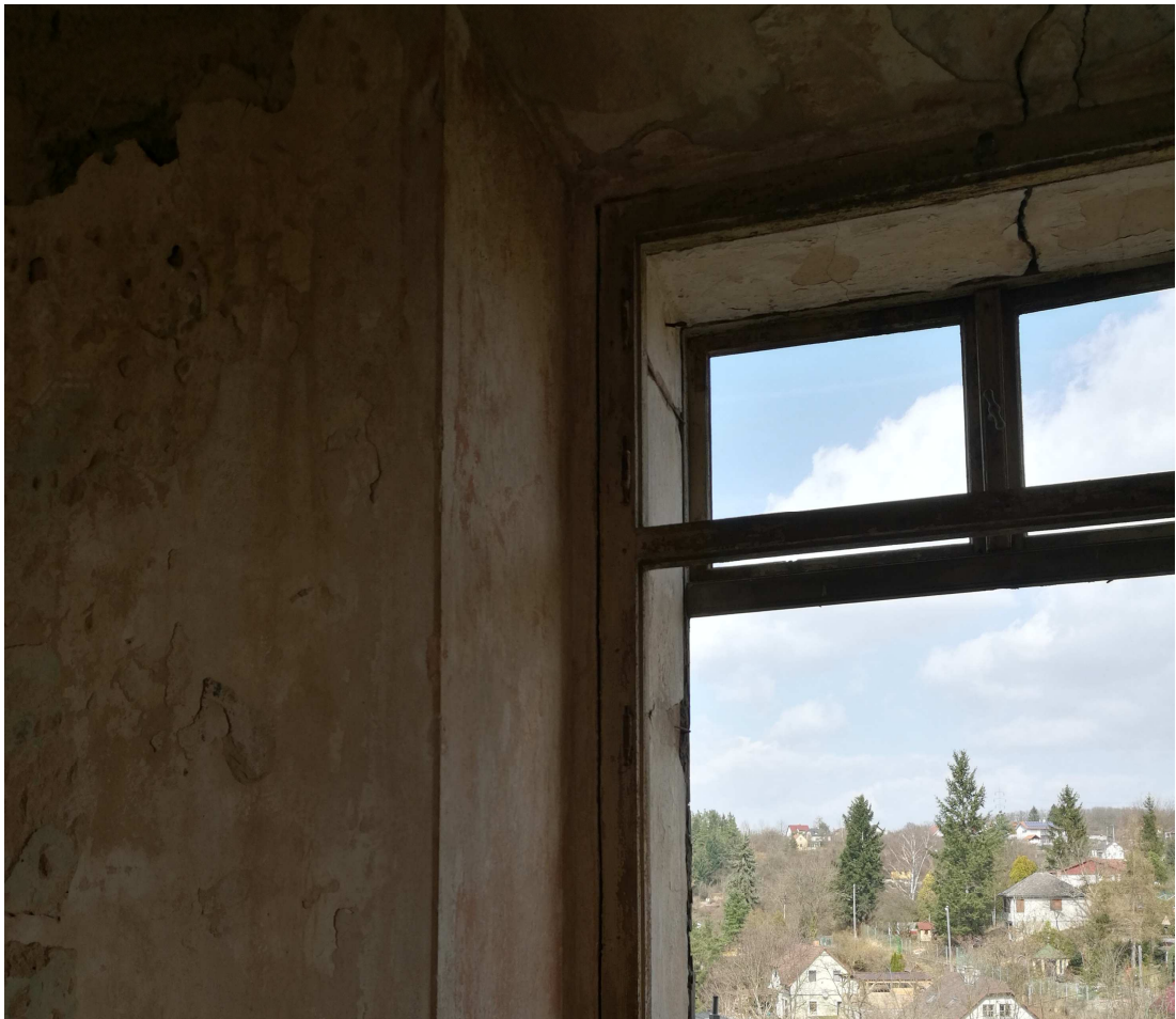
Obr. 17 trhlina v nadpraží okna T20i
