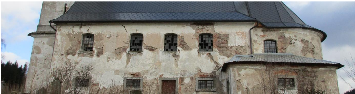
Obr.34.: Jižní strana kostela – poškození omítek a stěn.
