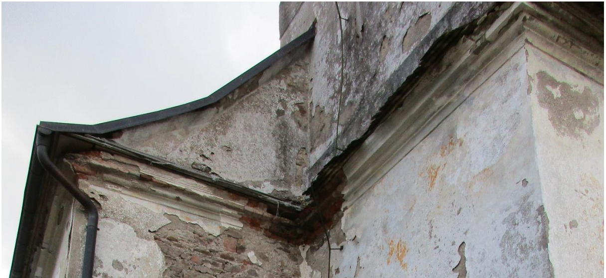
Obr.33.: Poškozená římsa ve styku věže s lodí.
