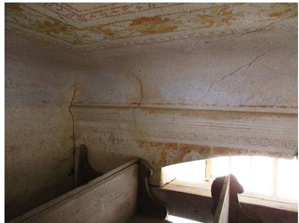
Obr.37.: Trhliny v nadpraží okna ve 2.NP.
