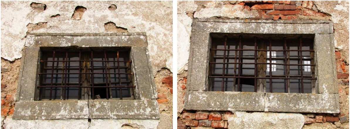
Obr.57,58: Prasklé dolní bloky pískovcových ostění.
