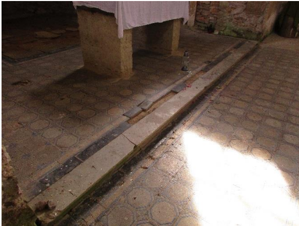
Obr.53.: Poškozená dlažba před oltářem.
