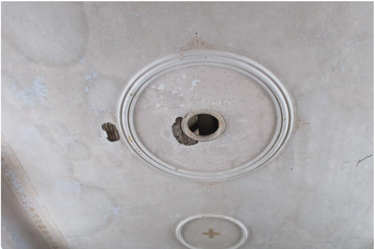
Obr.39.: Pohled na zrcadla. Patrné jsou vlhkostní mapy a místa s odpadnutou omítkou.
