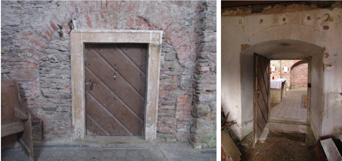
Obr.26,27.: Dveře z presbytáře do sakristie jsou umístěné v cihelném oblouku a lemované pískovcovým ostěním. Vpravo pohled na tytéž dveře ze sakristie.
