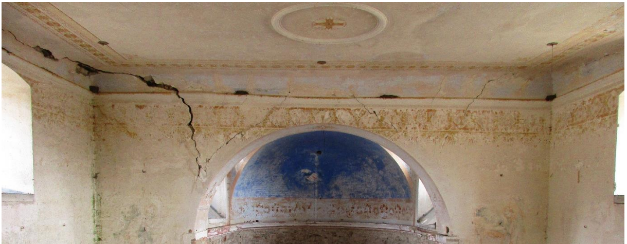
Obr.35.: Poškození vítězného oblouku.
