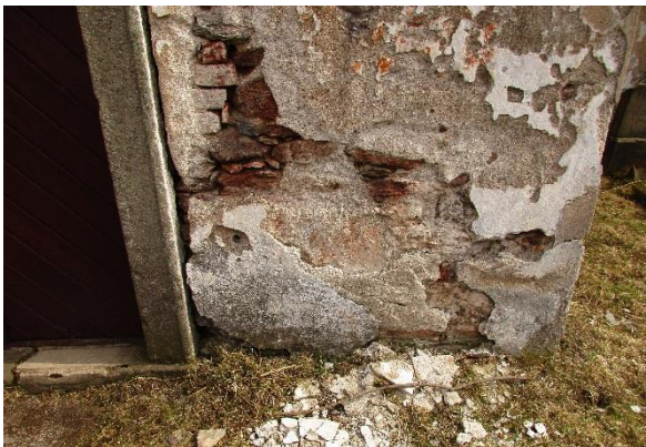
Obr.59.: Poškozené ostění hlavního vstupu.
