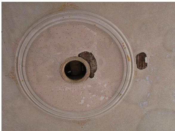
Obr.51.: Poškozený strop lodi.
