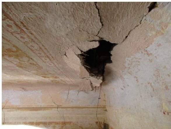
Obr.52.: Propadlý strop nad kůrem.
