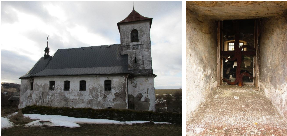
Obr.21,22.: Okna severního průčelí lodi. Malé okno vedoucí pod kůr a řada pěti oken v úrovni 2.NP. Skleněné tabulky jsou z velké části rozbité. Vlevo pohled na kovanou mříž okénka pod kůrem.
