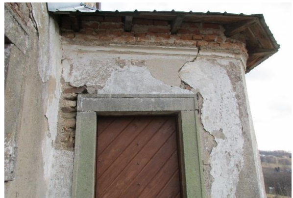
Obr.60.: Trhlina u vstupu do sakristie.
