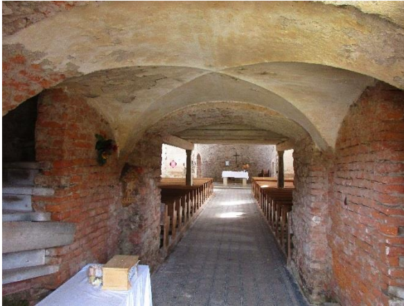
Obr.11.: Zaklenutí prostoru pod věží.
