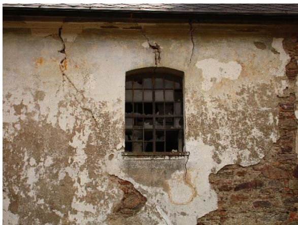
Obr.46.: Trhliny okolo okna.
