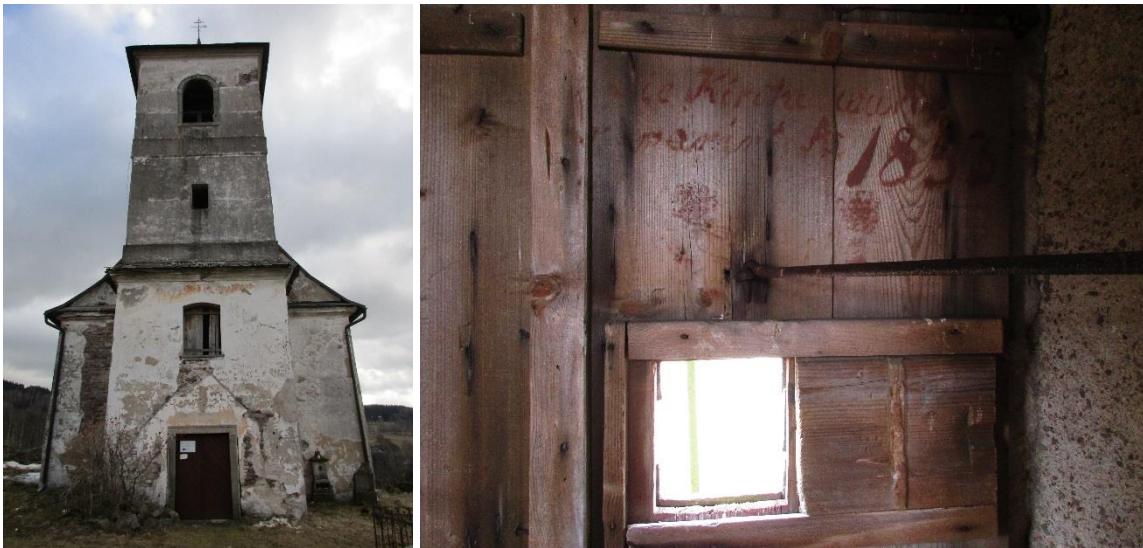
Obr.19,20.: Pohled na západní průčelí. Hlavní vstup, nad ním (v současnosti zabeďněné) okno ve 2.NP, dále štěrbinové okno a okno zvonového patra s pískovcovým ostěním. Vpravo pohled zevnitř na okenici s malým okénkem.
