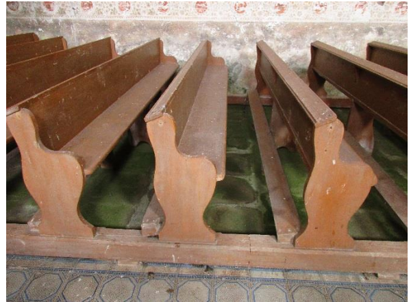
Obr.54.: Plísní pokrytá dlažba pod lavicemi.
