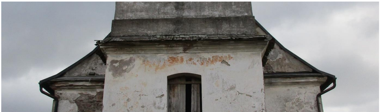
Obr.32.: Poškození krytiny kordonové římsy věže.
