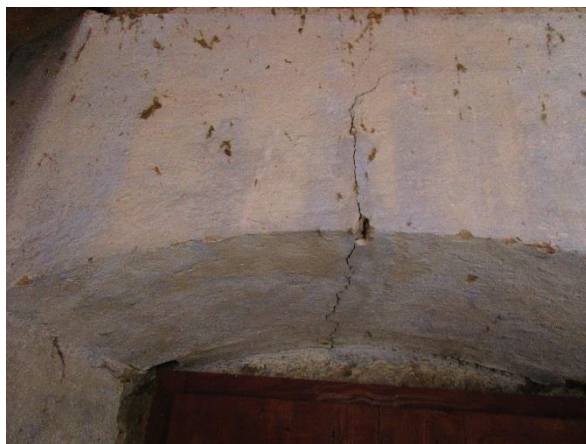
Obr.47.: Trhlina v nadpraží dveří sakristie.
