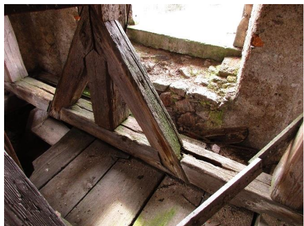
Obr.41: Poškození zvonových stojek.
