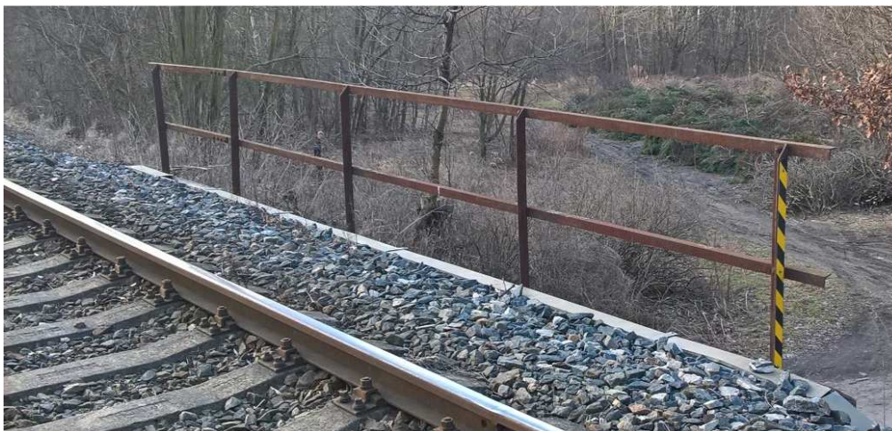
Obrázek 8 - Chránička kabelů a zábradlí na severní straně
