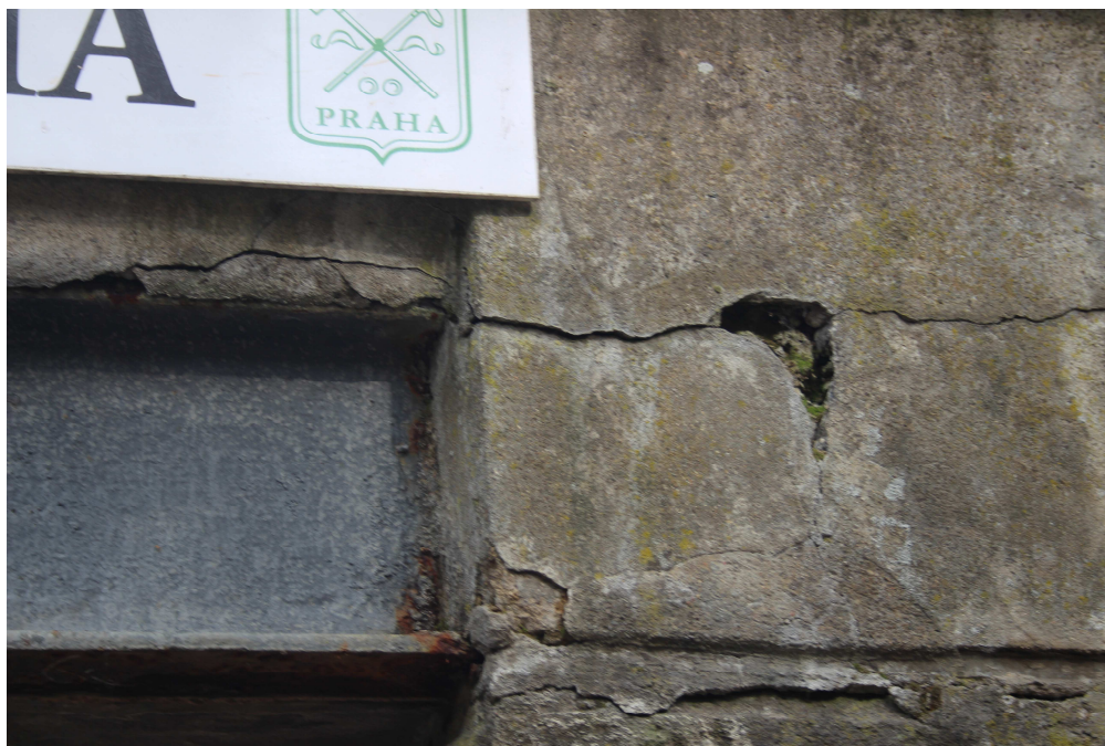
Obrázek 17 - Trhliny v místě uložení krajních nosníků
