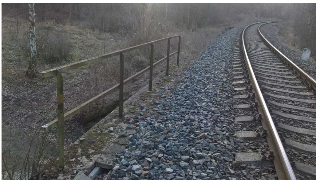
Obrázek 9 - Prázdná betonová chránička a zábradlí na jižní straně mostu
