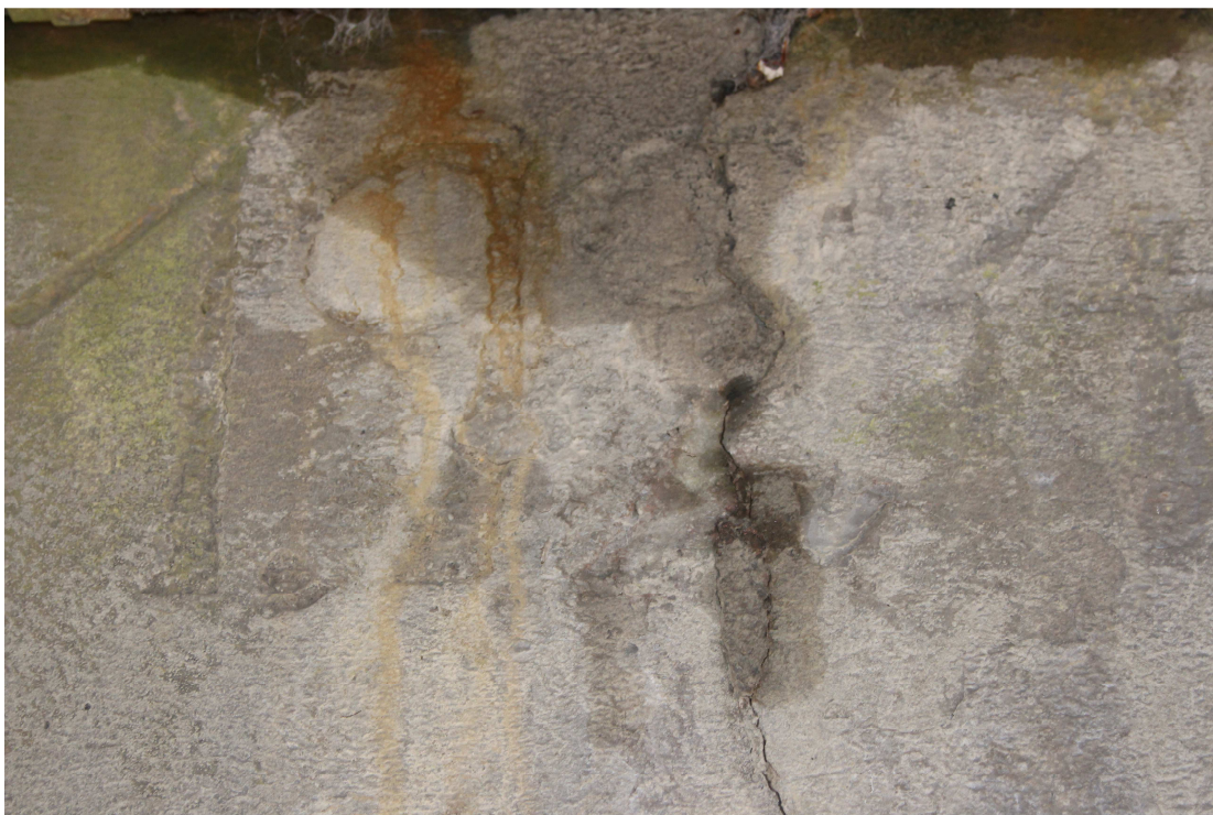
Obrázek 12 – Detail trhliny uprostřed středového úložného bloku na opěře O1
