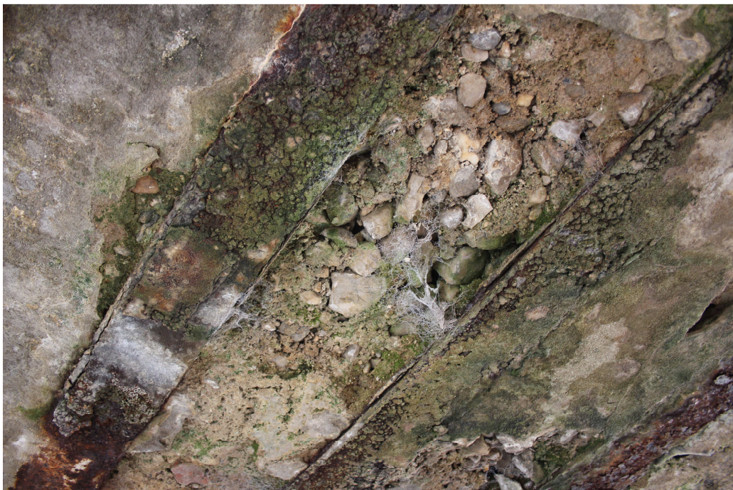
Obrázek 16 - Detail dolního povrchu nosné desky
