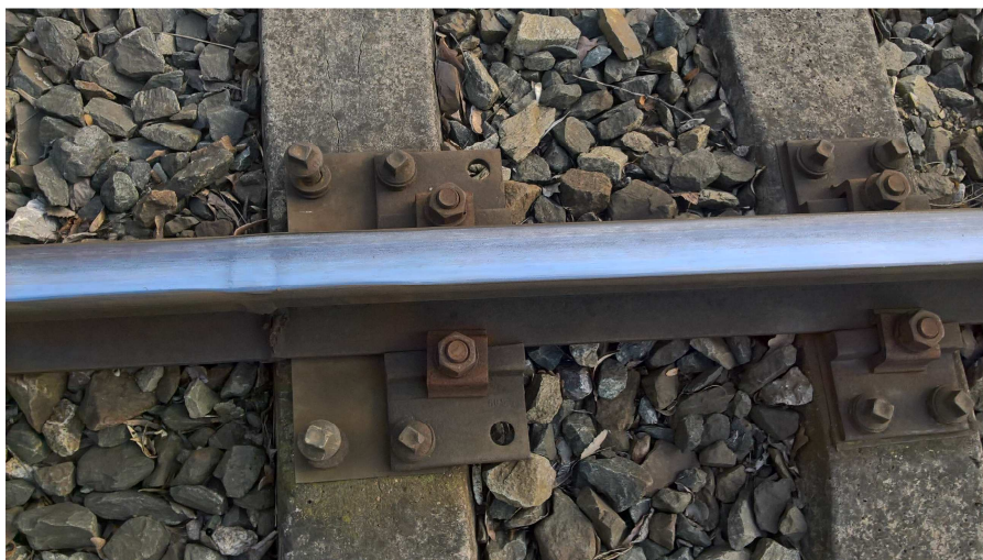
Obrázek 23 - Špatně instalovaná podkladnice
