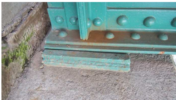
Obrázek 10 - Podélně posuvné ložisko na opěře O1
