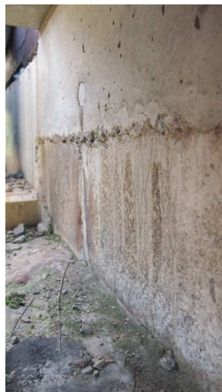
Obrázek 15 - Odprýskaná vrstva betonu na opěře O02
