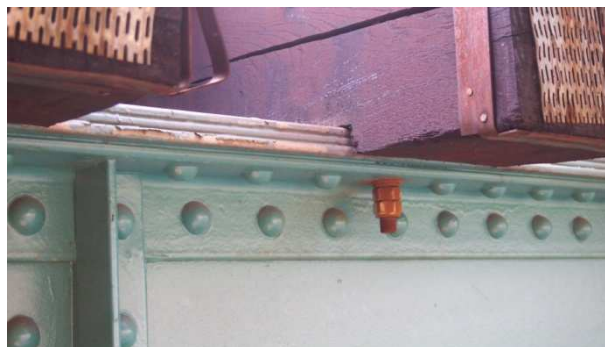
Obrázek 13 - Rez na mostnicovém šroubu, odloupaná PKO na pásnicích hlavního nosníku
