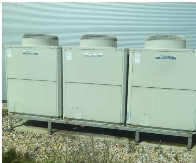
Obr. 4.1 Venkovní klimatizační jednotky
