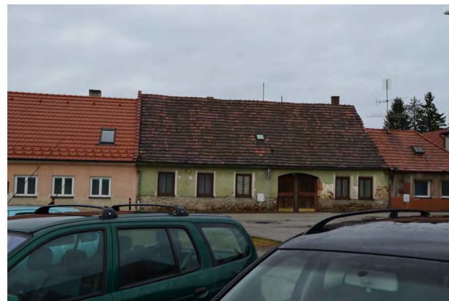
Obrázek 1.25: 15: Neudržovaná stavba, vlastní fotografie (březen 2017)
