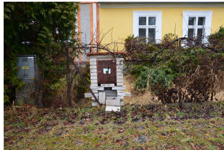
Obrázek 1.28: 18: Rozpadlý sloupek, vlastní fotografie (březen 2017)
