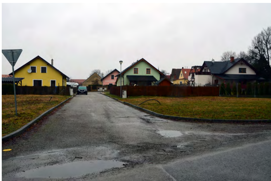
Obrázek 1.11: Problém 1: Špatný stav vozovky, vlastní fotografie (březen 2017)
