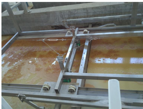
Obr. 3 Flotační zařízení na ÚV Bedřichov [vlastní foto]
