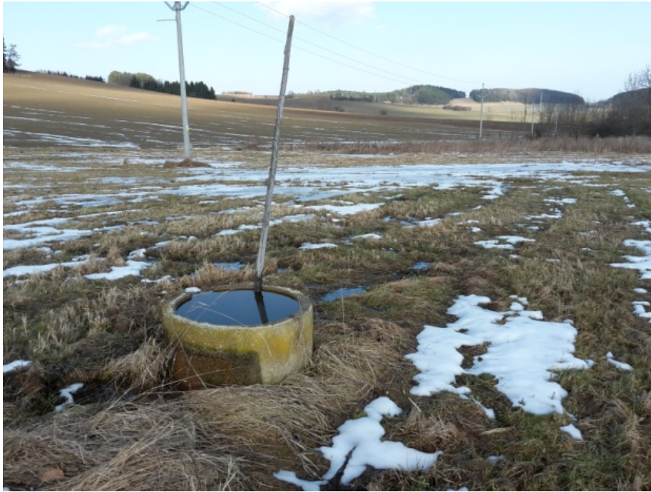
obr. 3.8 Zatopená šachta S3 nad místem poruchy drenáže
