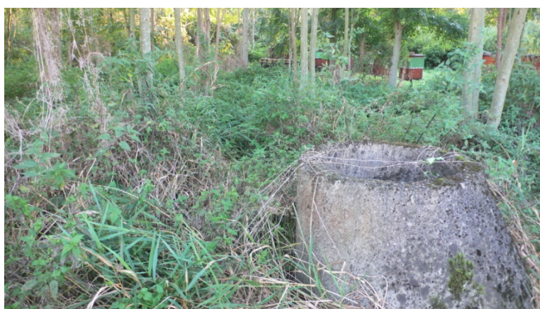
obr. 3.4 Šachta trubní drenáže na pozemku, plánovaném pro odkup investorem.
