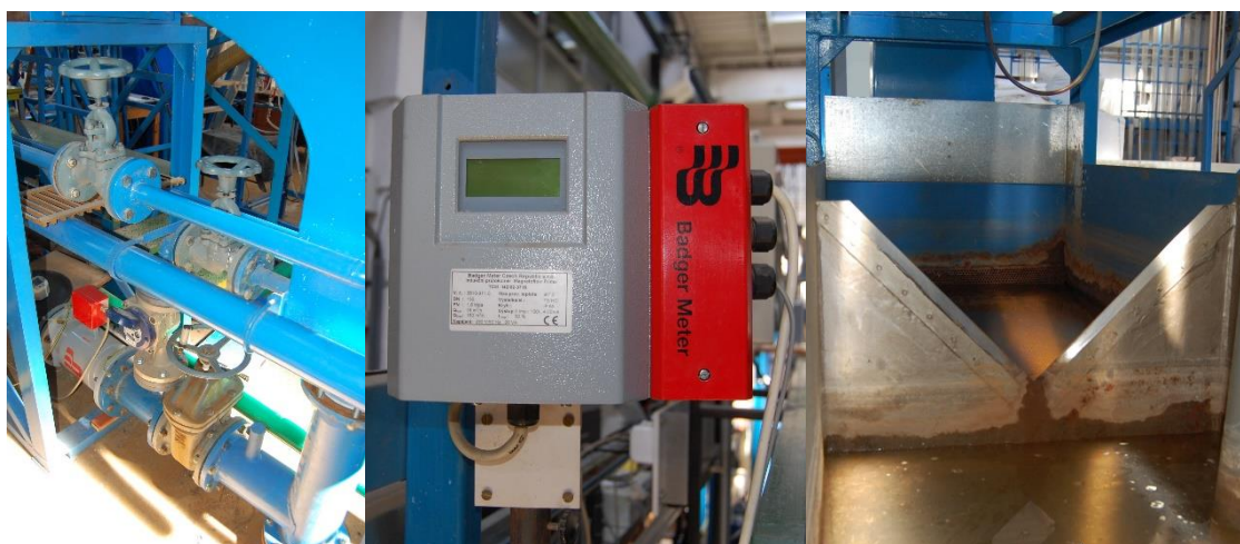
Obrázek 28 Ventily s osazeným průtokoměrem (vlevo) , Vyhodnocovací jednotka průtokoměru (uprostřed) , Thomsonův přeliv (vpravo)
