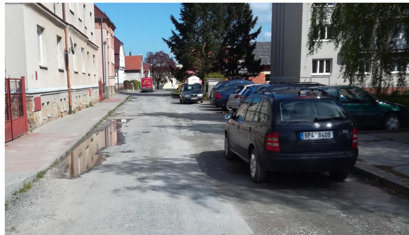
Obr. 31: Špatný technický stav místní komunikace (popraskaný asfalt s výmoly). Zdroj: vlastní fotografie
