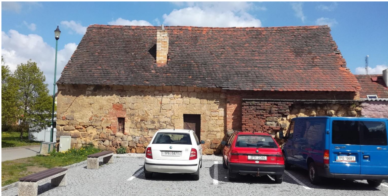
Obr. 28: Chátrající budova ohrožující přilehlé parkoviště. Zdroj: vlastní fotografie
