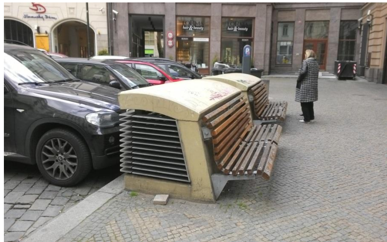
Obrázek 27: Výdechy kolektoru C1A u Senovážného náměstí [vlastní zdroj]
