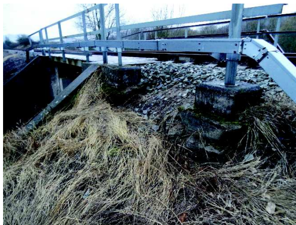
Obr. 2.11: Nedostatečně zasypané zábradlí
