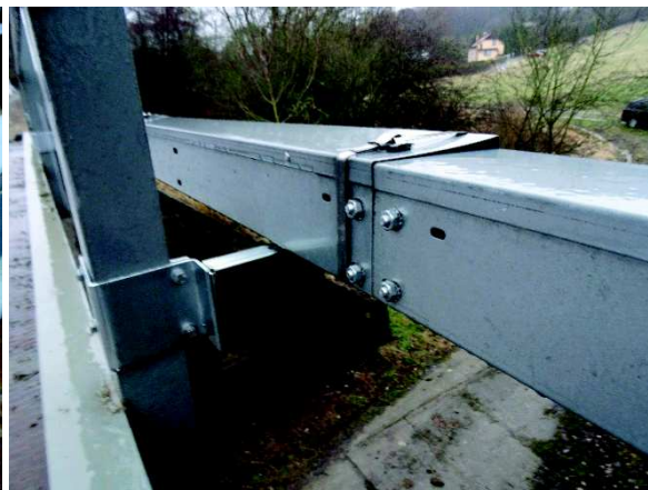
Obr. 2.2: Pravý kabelový žlab
