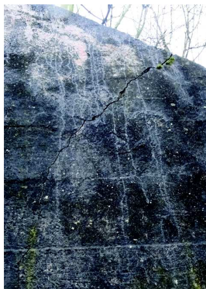
Obr. 2.15: Trhlina na levém křídle O 01
