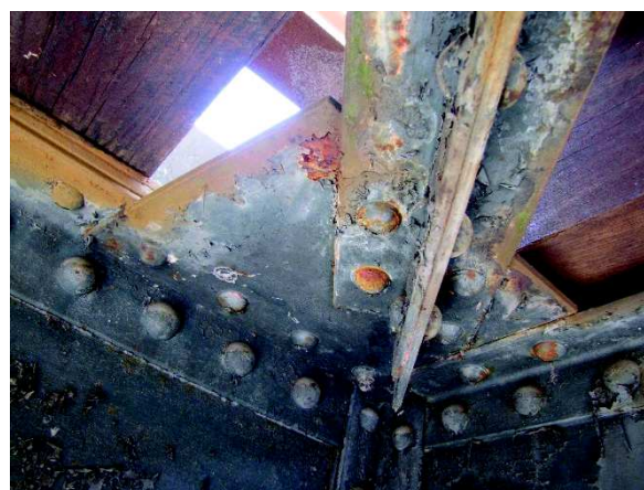
Obr. 2.12: Poškozená PKO nosné konstrukce (přípoj diagonály)
