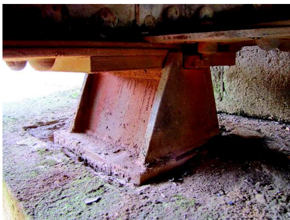
Obr. 2.6: Pevné ložisko na opěře O 01
