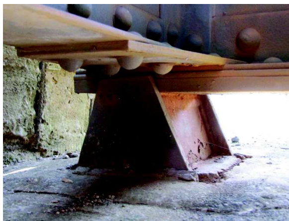
Obr. 2.7: Posuvné ložisko na opěře O 02
