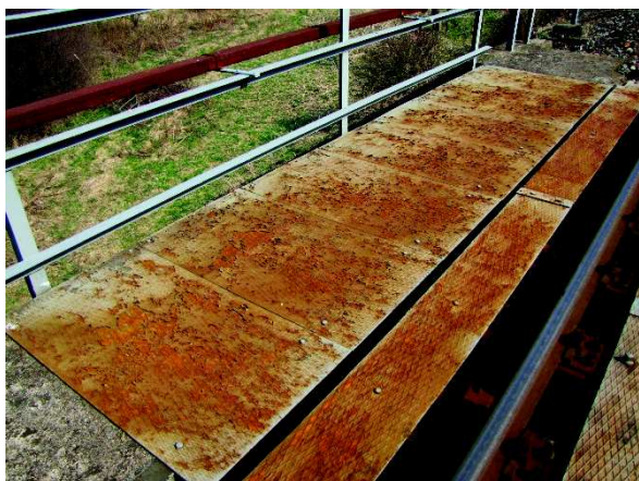
Obr. 2.10: Korozi oslabení chodníků
