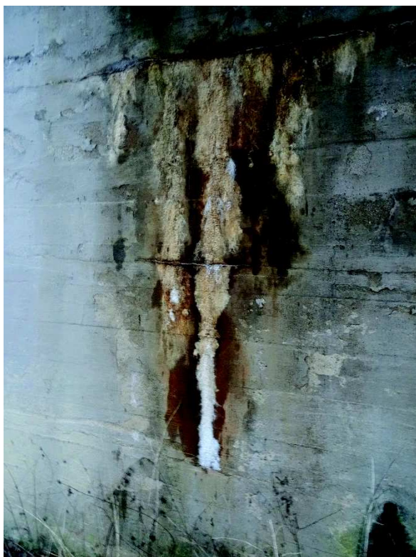
Obr. 2.13: Průsak voda a výluh pojiva na opěře O 01
