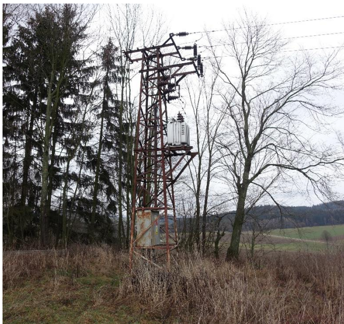
Obrázek 13: Současný stav TS
