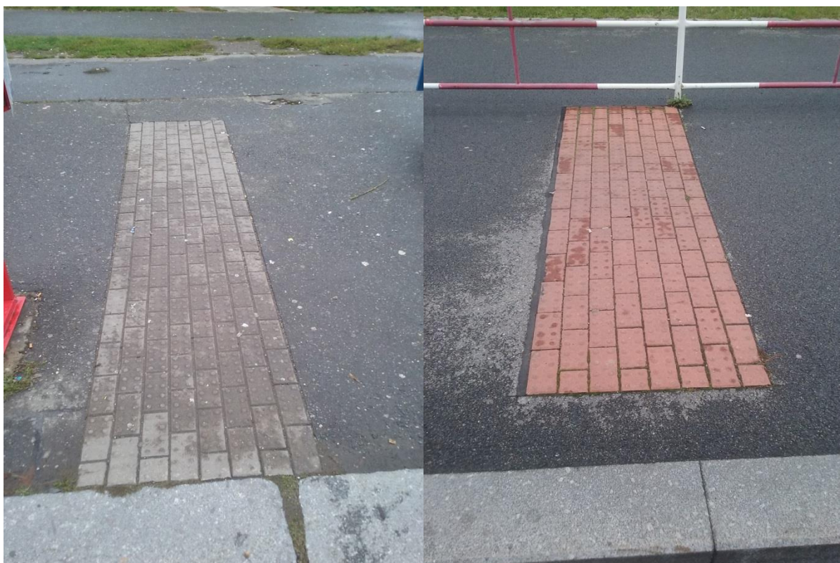
Obrázek č. 3: Signální pás na autobusové zastávce, vlevo – špatně, vpravo – správně (foto Kanclíř 2016)
