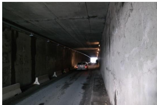
Obrázek 41 – CT č.4157 v železničním podjezdu
