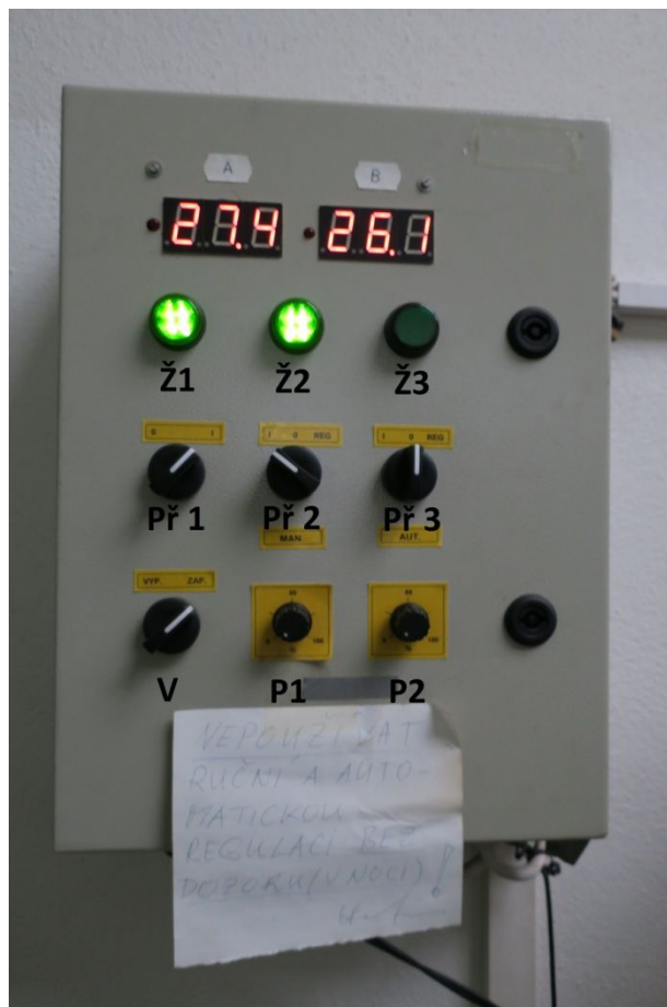
Obr. 7 – Ovládací skříňka elektrického ohřivače
