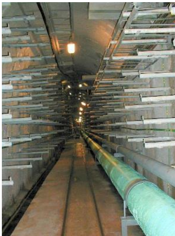
Obr. 1.21: Úložné konstrukce v hloubkovém kolektoru v Praze, (Pražské kolektory, 2015)
