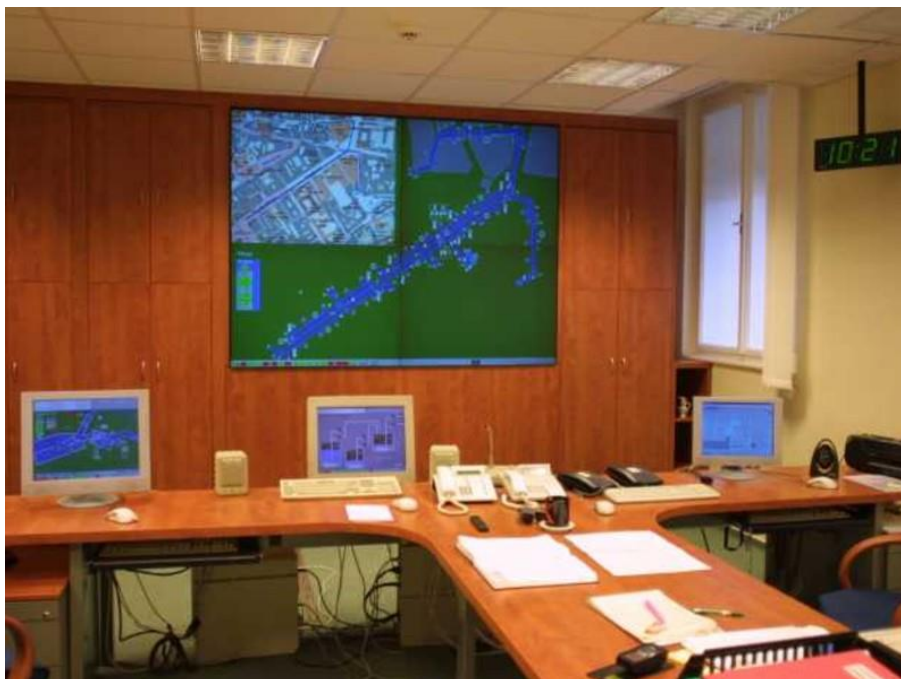
Obr. 1.23: Centrální dispečink - Kolektory Praha a.s., (Kolektory Praha a.s. - galerie, 2017)
