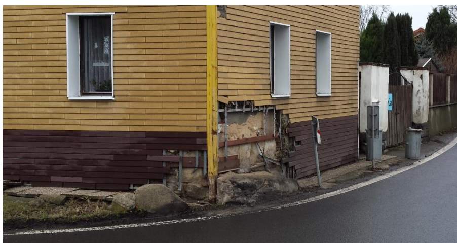
Obrázek 3 Zdevastované nároží budovy [2]
