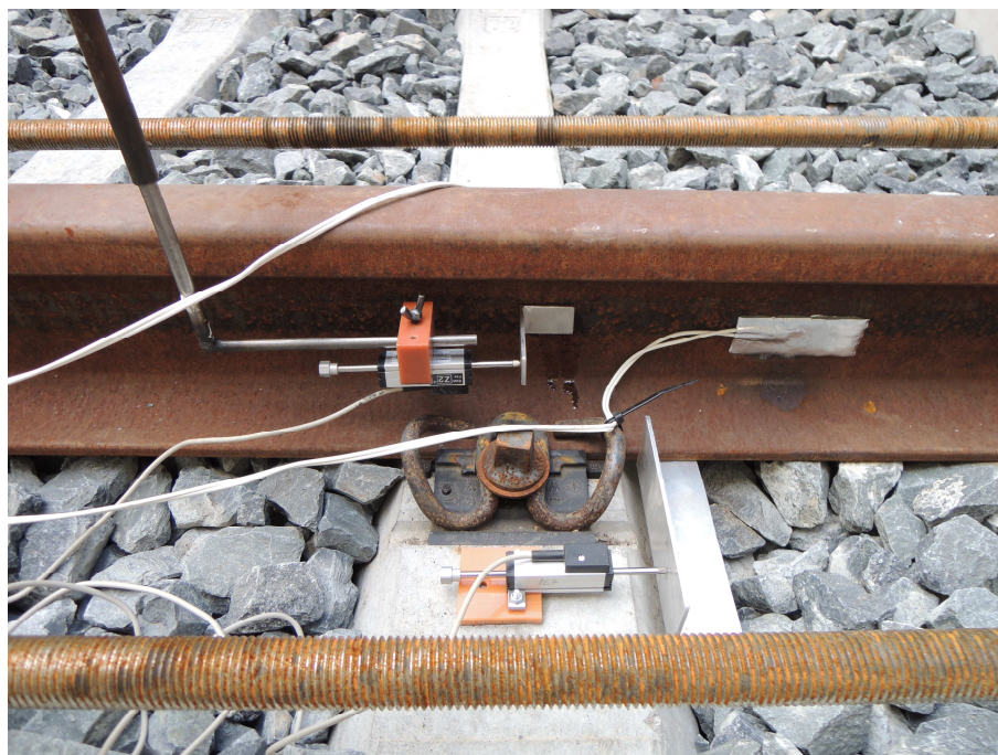
Obr. 45: Detail snímače na kolejnici a na pražci
