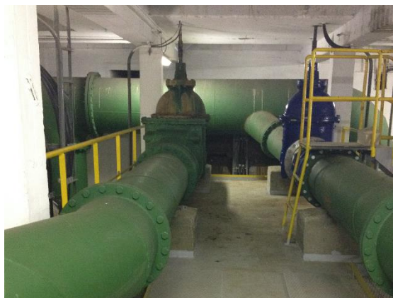
Obr. 16 – pohled na výtlaček čerpadel M4 (vlevo) a M3 (vpravo)
