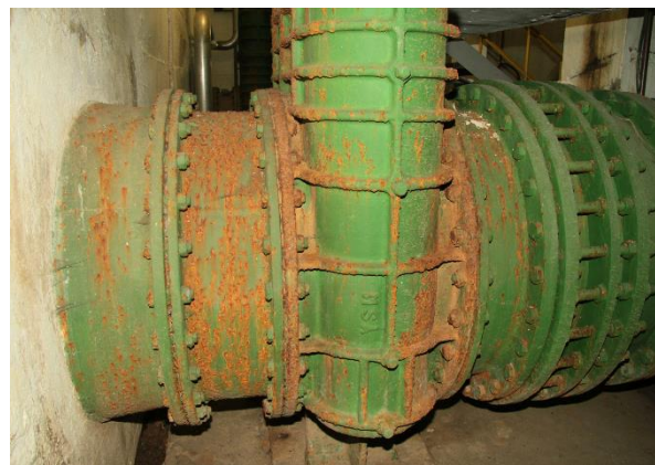
Obr. 17 – pohled na šoupě DN 1000 čerpadla M1
