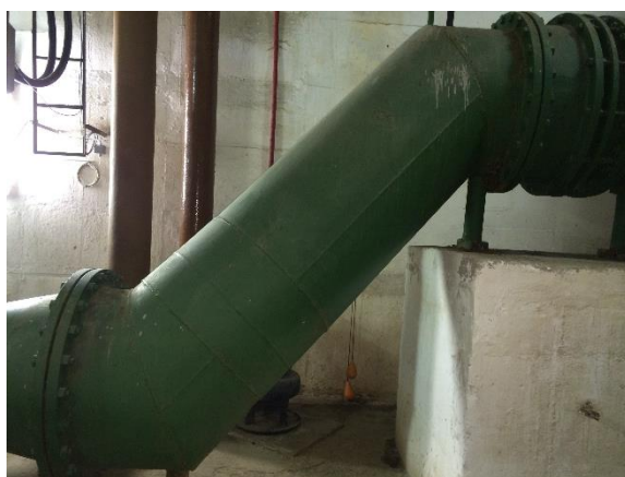
Obr. 20 - výtláčné potrubí čerpadla M2
