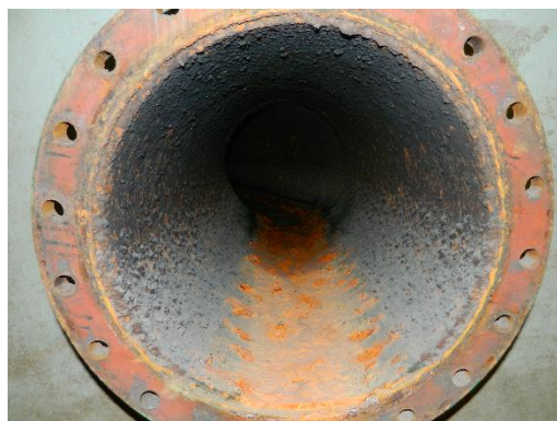
Obr. 19 – vnitřní povrch potrubí DN500 výtlak čerpadla M3
