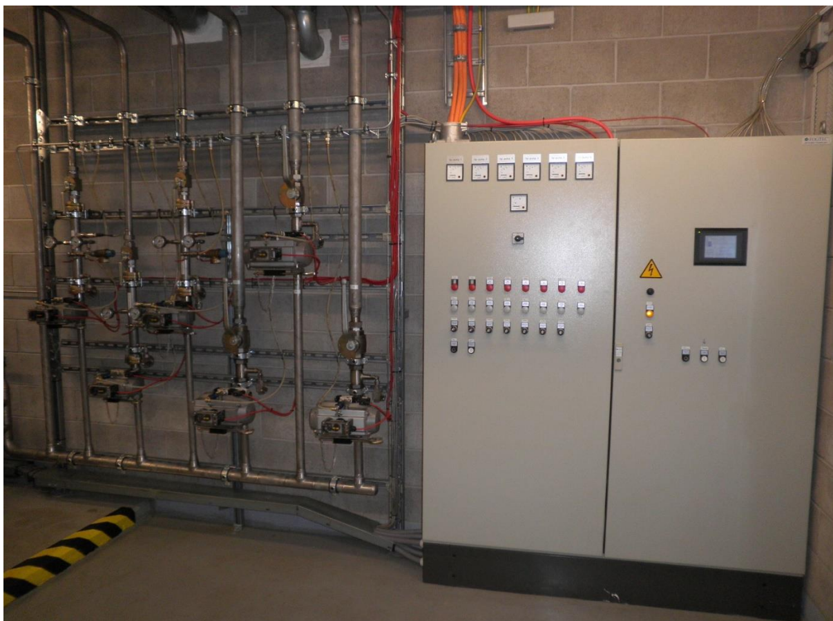
Fotografie 8 – Rozdělovač, ventilová stanice a řídicí jednotka pro SHZ
