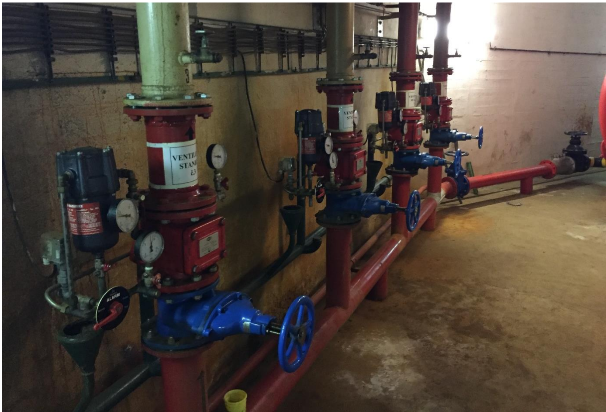
Fotografie 21 – Část ventilové stanice pro SHZ
