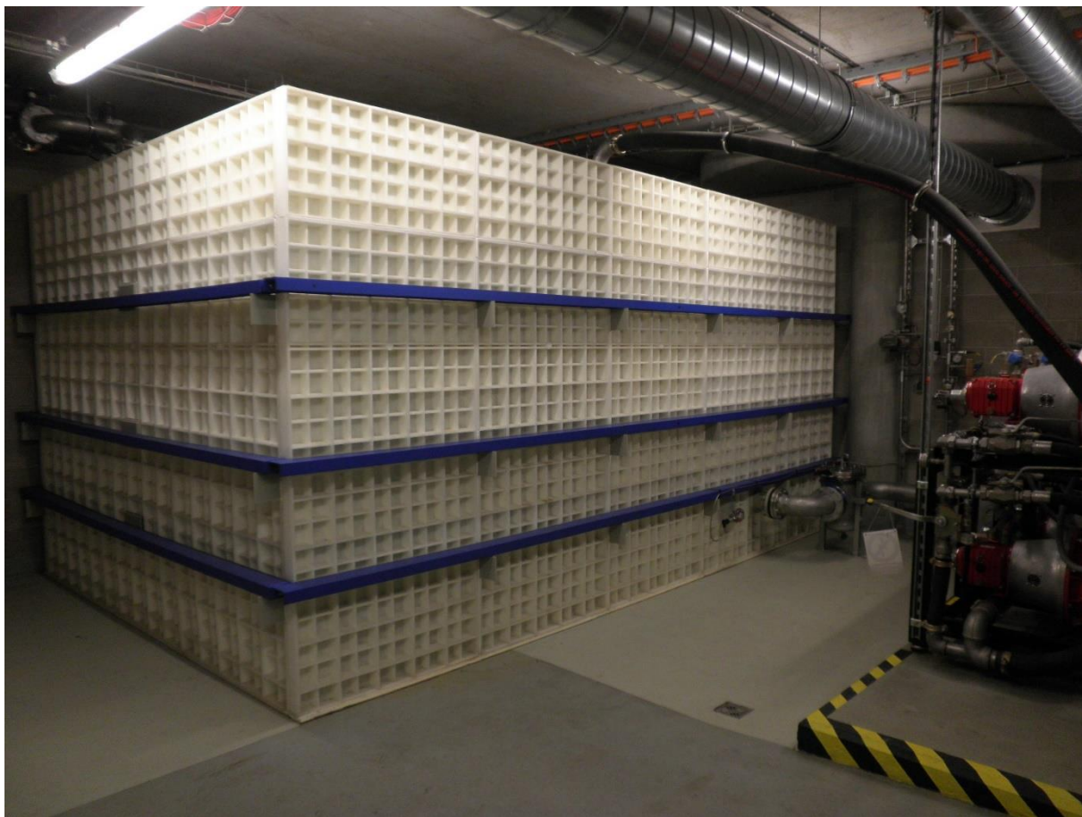
Fotografie 7 – Nádrž na vodu pro SHZ
