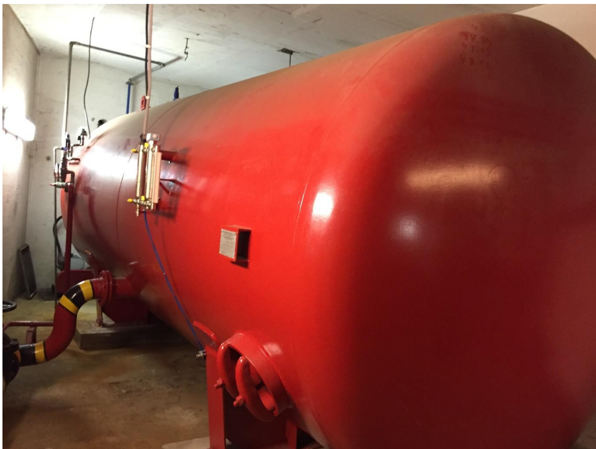
Fotografie 22 – Nádrž na vodu pro SHZ
