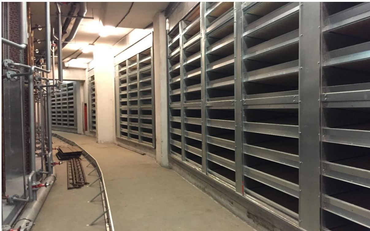
Fotografie 12 – Vzduchové filtry za chladičovými stěnami
