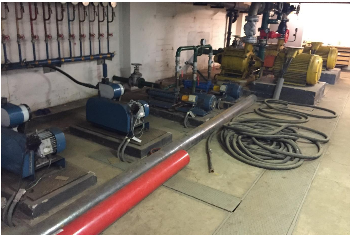
Fotografie 19 – Čerpadla pro SHZ
