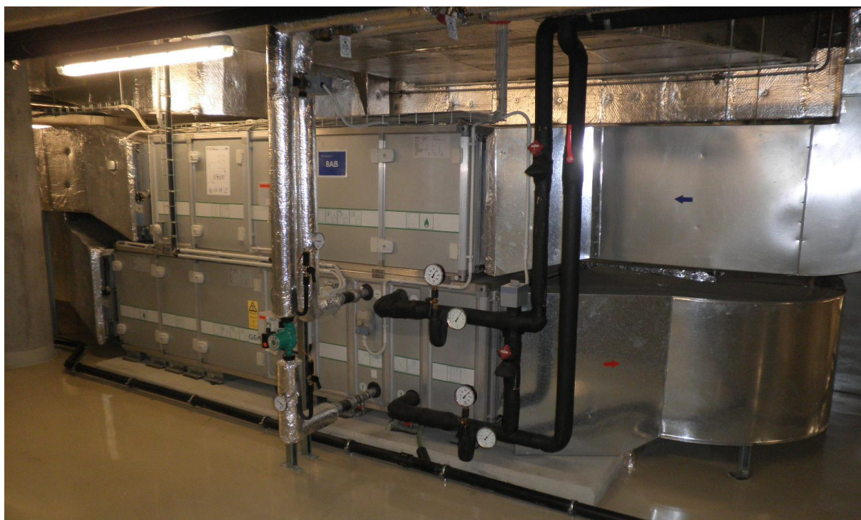
Fotografie 1 – VZT jednotka
