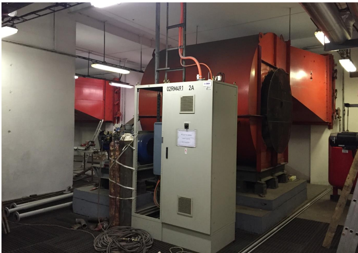
Fotografie 10 – Ventilátor pro přívod vzduchu
