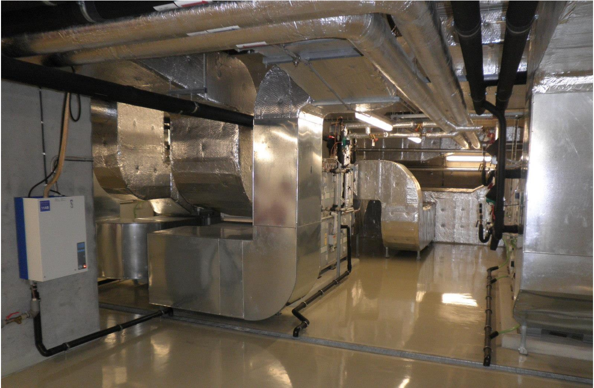
Fotografie 4 – Strojovna VZT
