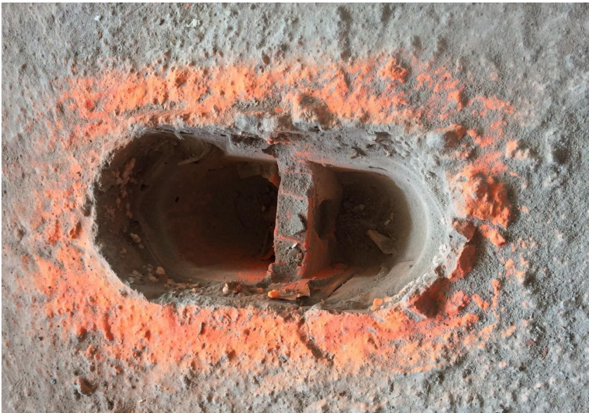
Obrázek 20: Výsledný kotevní bod v ŽB stropní konstrukci před začištěním [archiv spol. Skanska a.s.]
