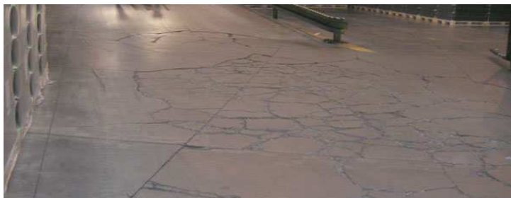
Obrázek 10: přetížená podlaha pod rampou
