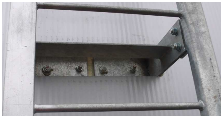
Obrázek 13: tepelný most přes ukotvení žebříku
