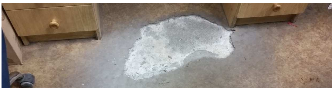
Obrázek 9: prodřená podlahová krytina v místě pojezdu židle
