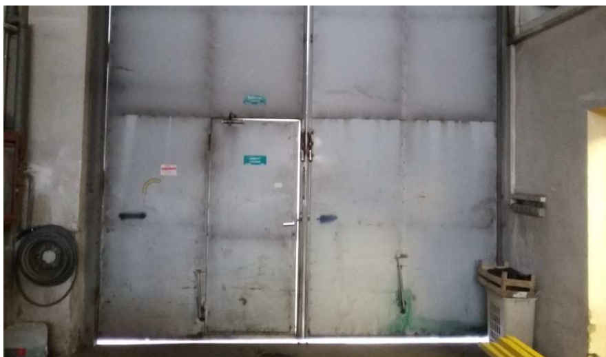
Obrázek 12: netěsná vrata po celém obvodu
