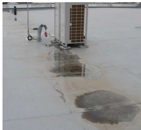
Obrázek 7: tvoření louží vlivem nedostatečného sklonu
