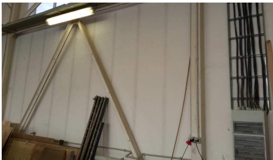
Obrázek 15: kondenzace v místě ocelových profilů
