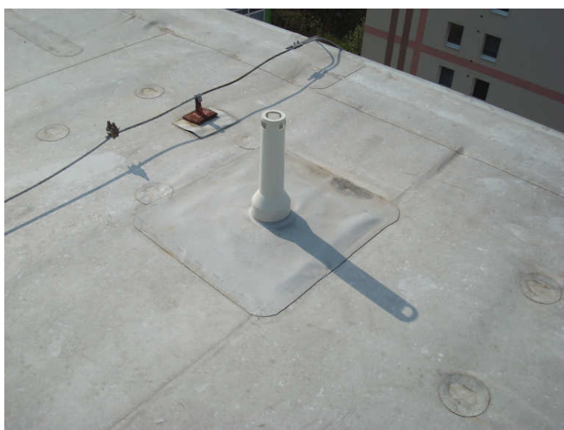
Obrázek 2.1-3: Absence krytu odvětrávacího komínku
