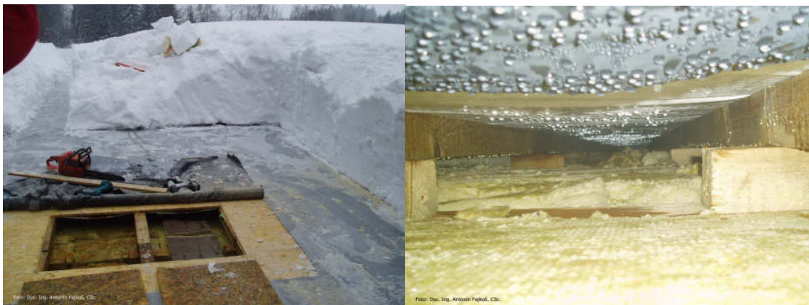
Obrázek 1.3-2: Špatně navržená dvouplášťová střecha s kondenzací na spodním povrchu horního pláště [22]
