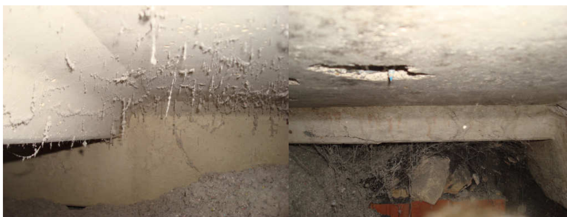
Obrázek 2.1-8: Prostor dutiny u sondy č. 2 (u atiky) a sondy č. 1 (u vpusti)
