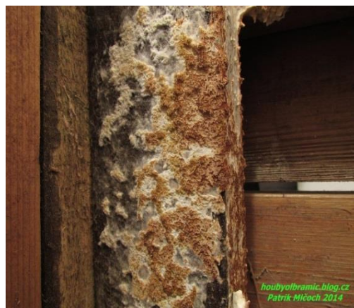
Obrázek 11: Dřevěný prvek napadený konioforou sklepní (7).
