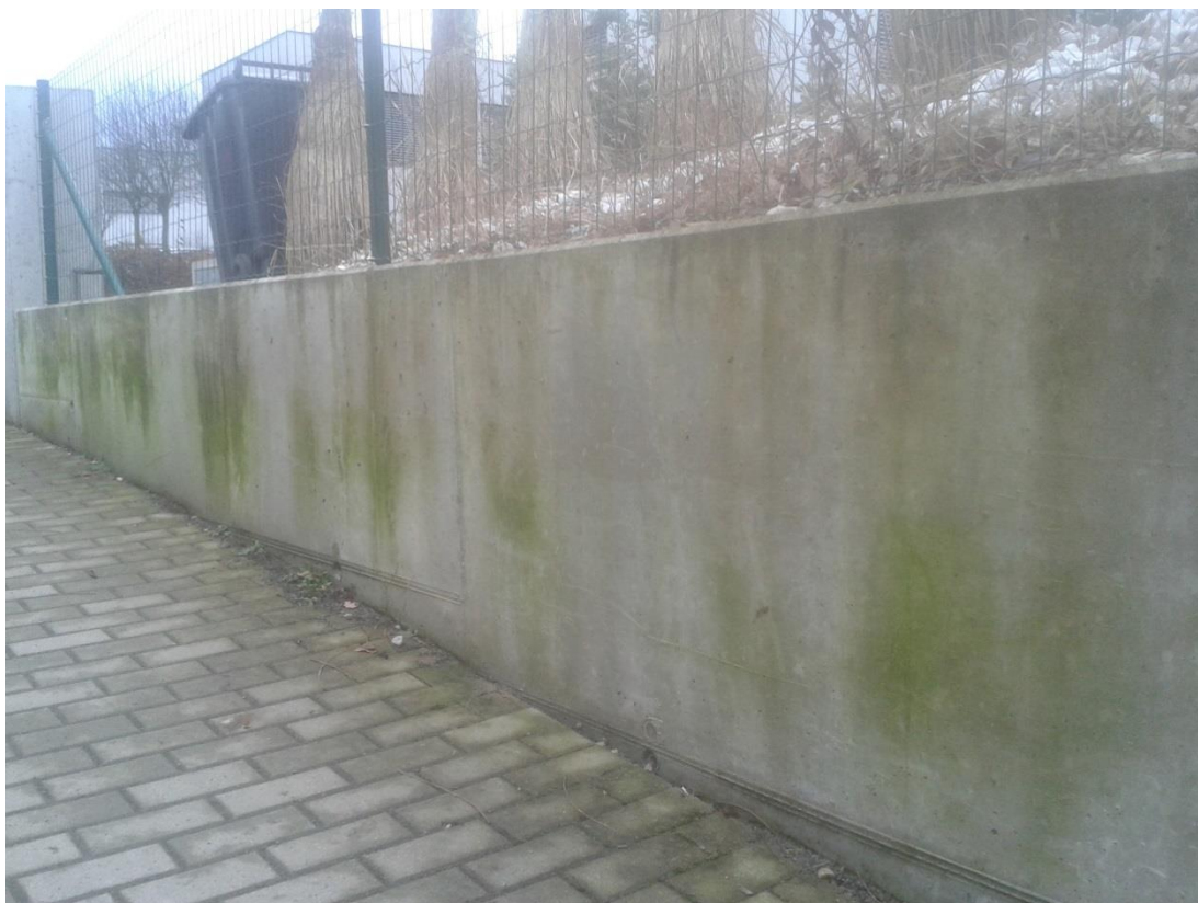
Obrázek 5: Stavba esteticky znehodnocená porostem řas (1).
