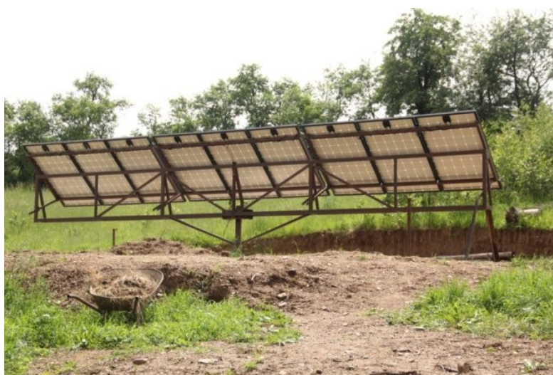
Obrázek 22 - Konstrukce FV elektrárny k natáčení vůči světovým stranám (autor)
