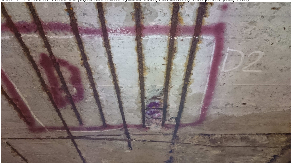
Obr.14 Pohled na sondu D2 (stykování hlavní výztuže desky; distančníky tvoří příčné pruty Rox)
