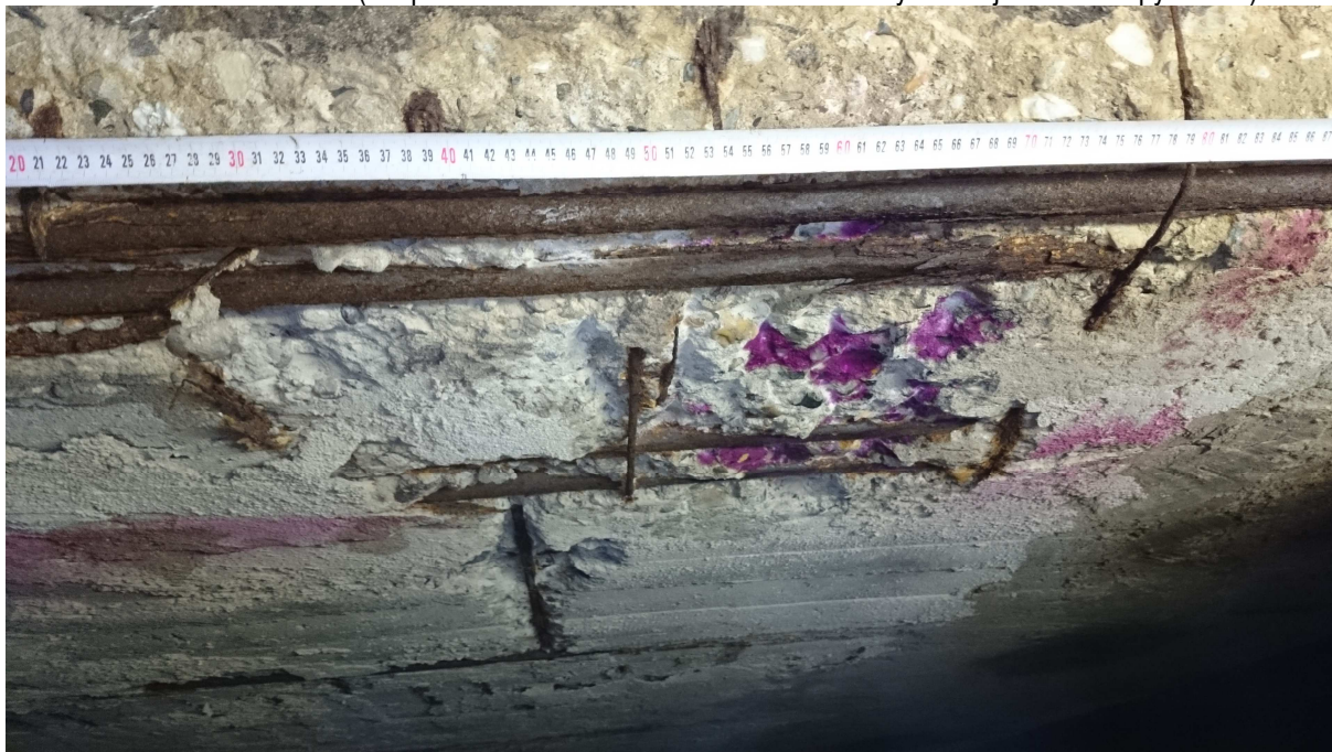
Obr.15 Pohled na sondu D3 (stropní deska s lokálním zesílením – oblast bývalé nájezdové rampy z ulice)
