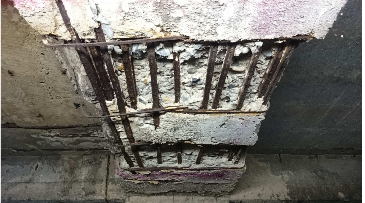
Obr.11 Pohled na sondu T3 (trám v místě stykování podélné výztuže; vybrané tříminky jsou zcela poškozeny)
