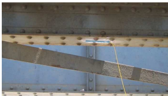
Obr. 33 FBG senzor použitý na železničním mostě Nea Peramos [30]
