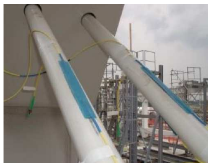
Obr. 34 FBG senzor použitý na konstrukci střechy letiště [31]
