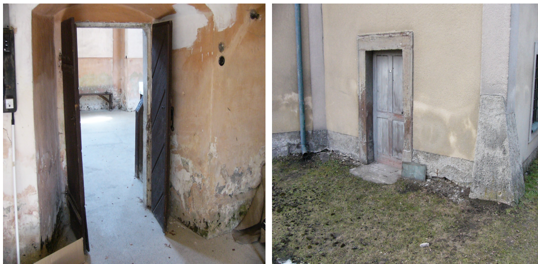
Foto 13: Kostel sv. Umučení sv. Jana Křtitele – projevy vlhkosti interiér (autor: Ing. Jiří Novotný)
