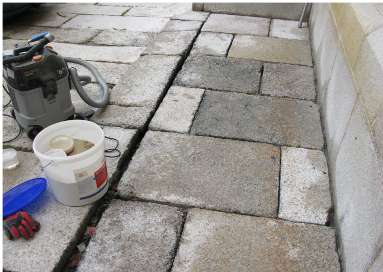
Foto 7: Kostel sv. Antonína Velikého – netěsnosti u spár kolem objektu (autor: Ing. Jiří Novotný)
