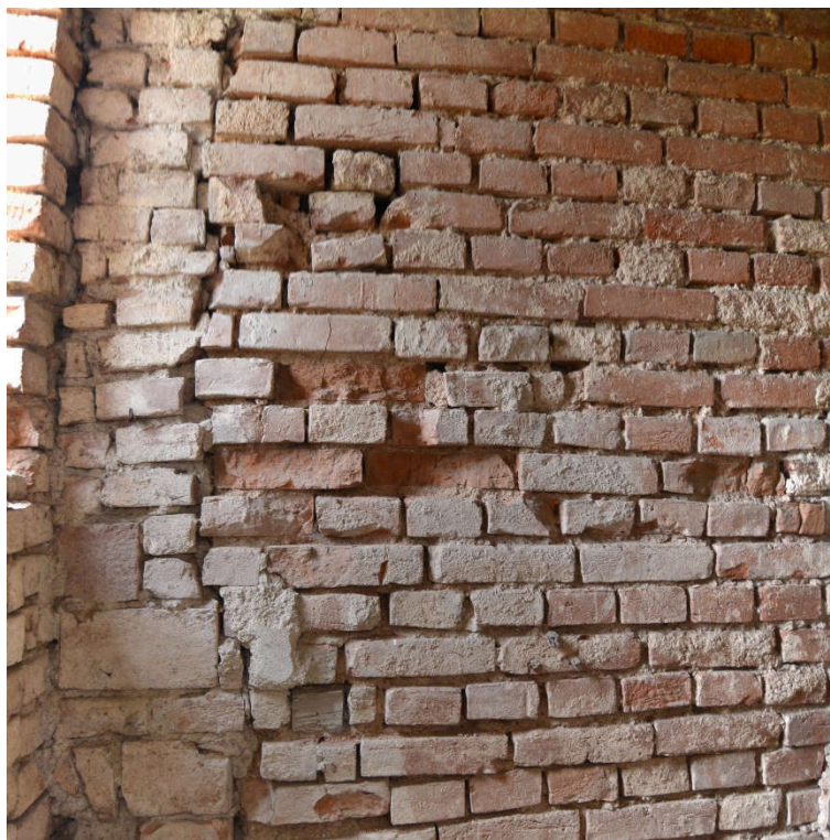
Obrázek 7 - Trhlina v místnosti 1.05
