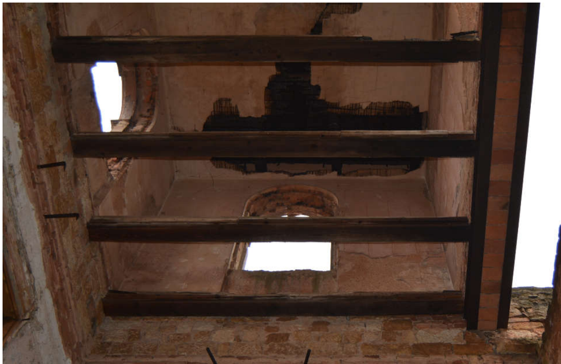
Obrázek 8 - Pohled na dochovanou rákosovou omítku a stropní trámy
