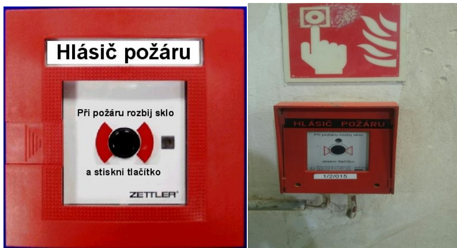
Obrázek 8 – Hlásič požáru napojený na EPS. [8]
