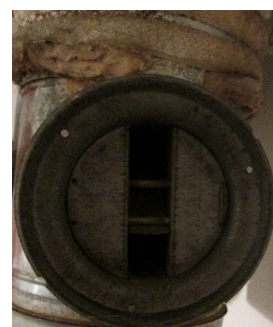
Obr. 17 Automatický regulátor průtoku vzduchu osazený v odbočce
