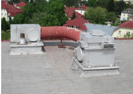
Obr. 3 Vlevo sběrná komora osazená na nástavci na vyústění ventilačních šachet, vpravo centrální ventilátor připojený sběrným potrubím
