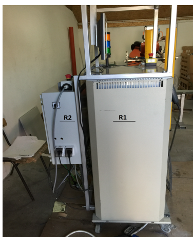
(b) : Bočný pohľad na rozvádzače
