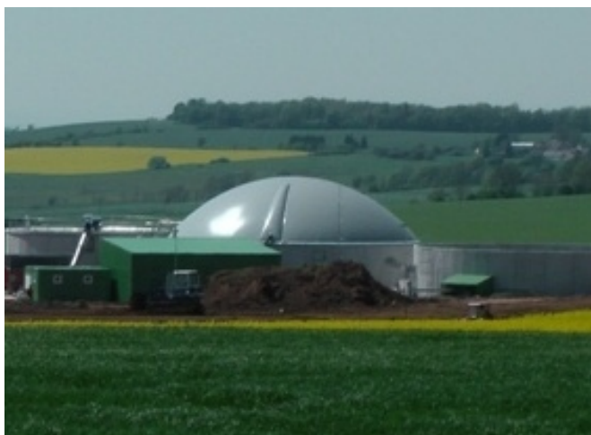
Obr. 7-3 Bioplynová stanice Číčov [49]
