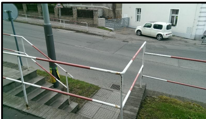
Obrázek 72 Nevhodný přechod pro chodce (ulice Nad Náměstím)
