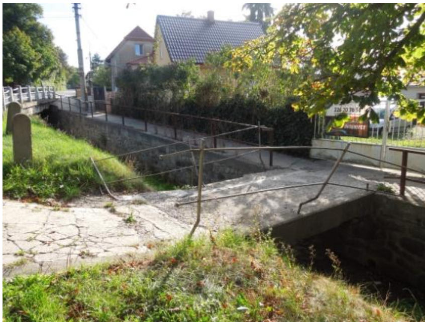
Obrázek 23 - Lávka s poškozeným bezpečnostním zábradlím
