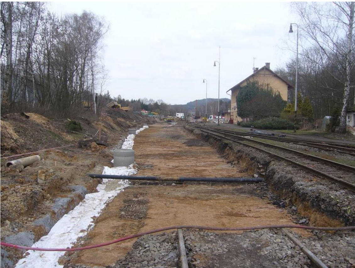
Obrázek F.6: Rekonstrukční práce v žst. Mirošov, vlevo patrné budování trativodu (27. března 2016)
