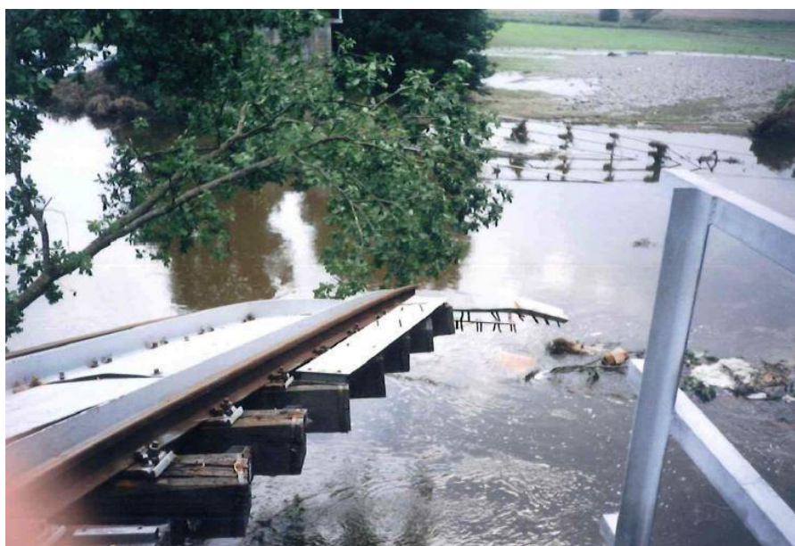
Obrázek 6: Stržený most přes řeku Úslavu na trati 175 při povodních v srpnu 2002
