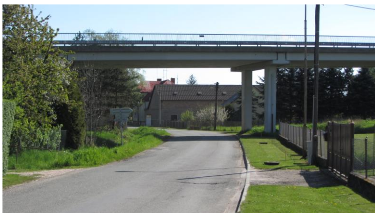
Obr. 27: Mostní objekt na silnici I/35 a pod ním místní komunikace ve Všestarech, směr do středu obce
