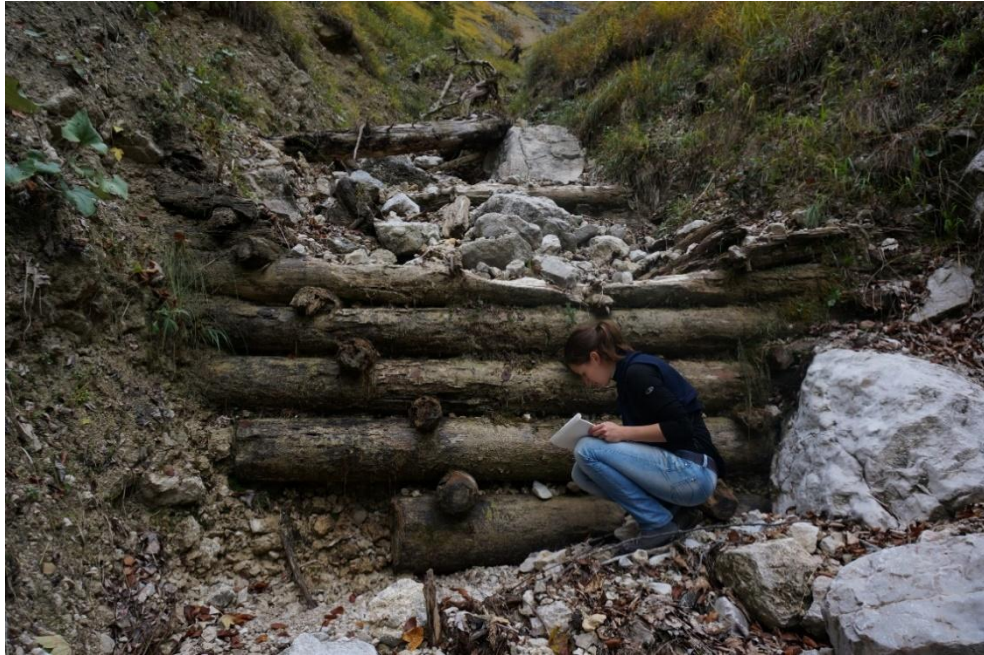
Obrázek 23: Dřevěný stupeň na strži Holzschlaggraben
