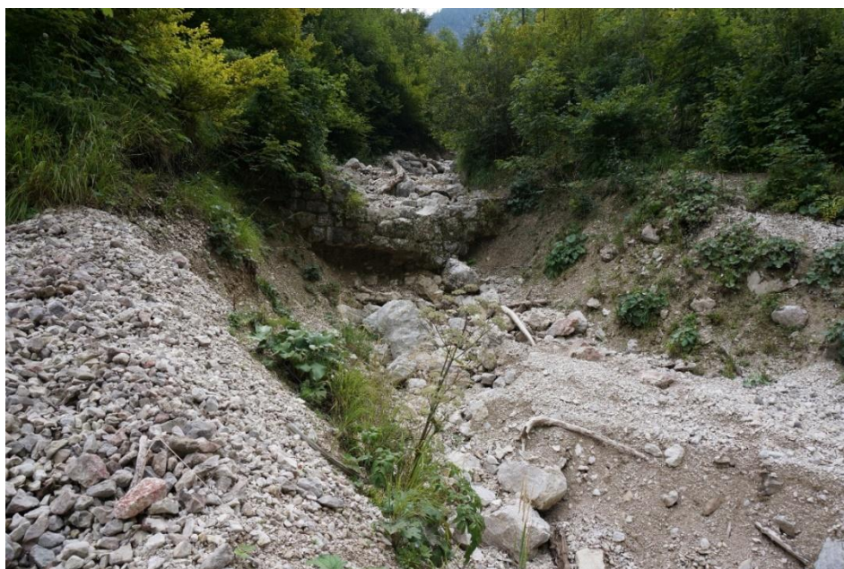
Obrázek 28: Závěrová kamenná přehrážka na Schüttinggraben
