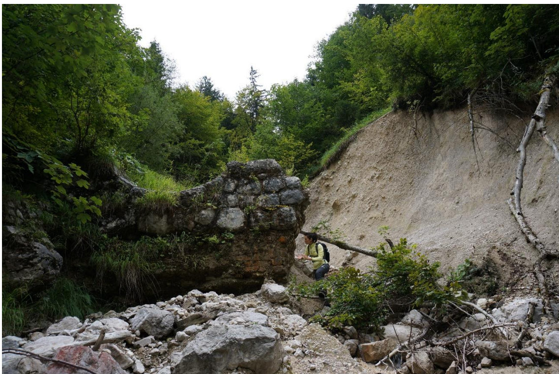
Obr. 8: Poničená kamenná přehrážka – strž Holzschlaggraben na povodí Gimbach
