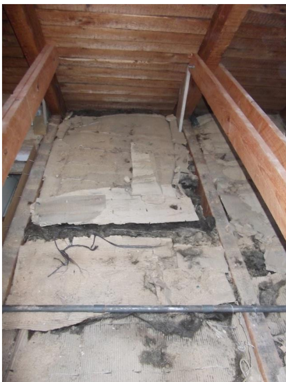
Obrázek 12: Původní izolant – skelná vata Zdroj: Autor
