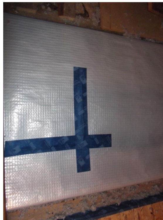
Obrázek 77: Znovuutěsnění fóliového záklopu Zdroj: Autor
