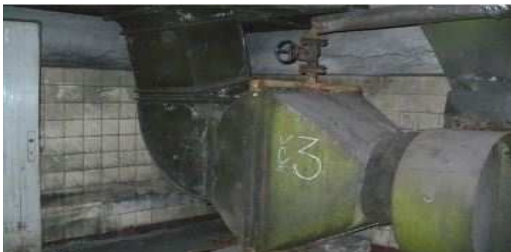
Obrázek 29- Stávající strojovna VZT (zdroj: vlastní)
