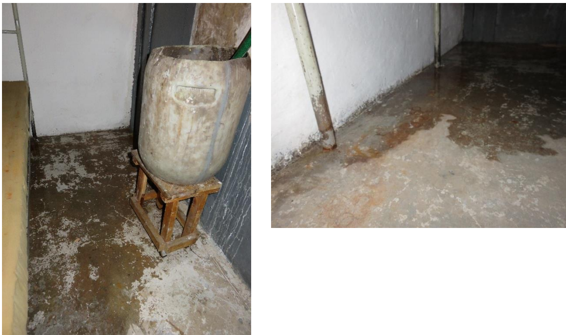
Obrázek 88: První známka protékání vody mimo odvodnou trubku (foto autorka 4. 12. 2015)
