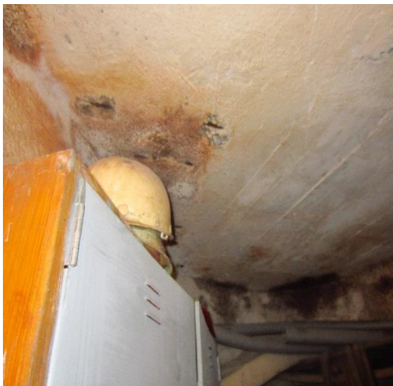
Obrázek 25: Obnažená výztuž, pancéřový zvon
