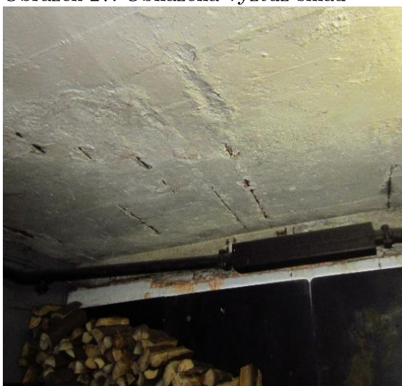
Obrázek 29: Obnažená výztuž kotelna
