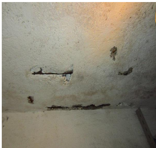
Obrázek 28: Obnažená výztuž, sklad
