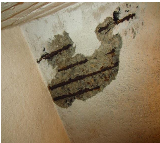
Obrázek 27: Obnažená výztuž sklad
