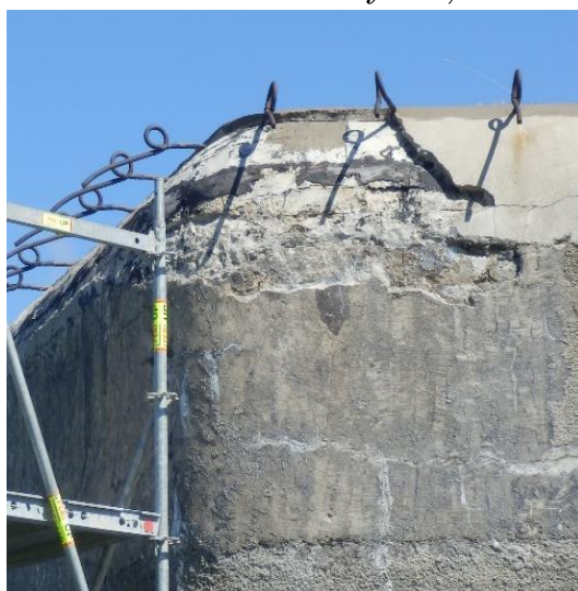
Obrázek 30: Chybějící část betonu
