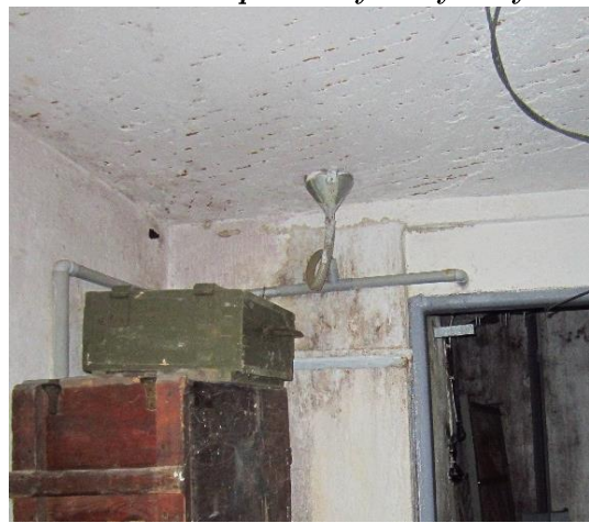
Obrázek 16: Výkvěty a obnažená výztuž
