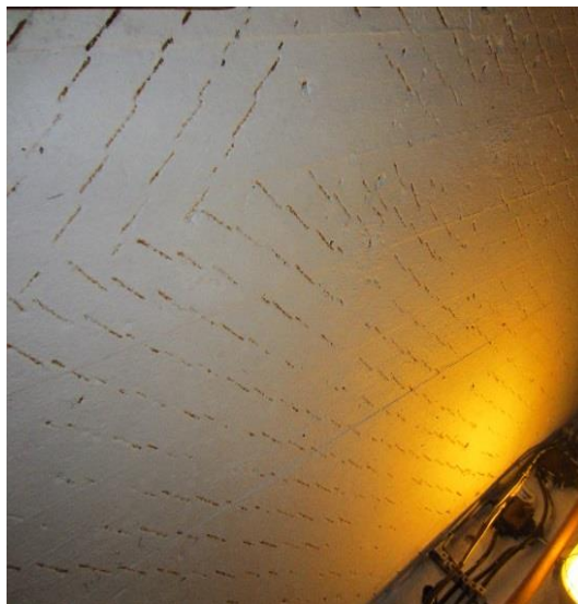
Obrázek 26: Obnažená výztuž, tech. místnost
