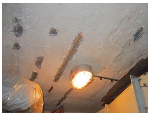
Obrázek 24: Obnažená výztuž, tech. Místnost
