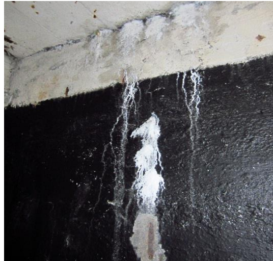
Obrázek 14: Vápenné výkvěty a výztuž
