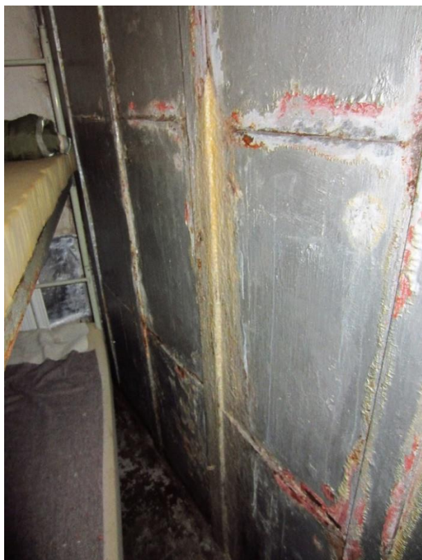
Obrázek 82: Vápenný výkvět na jižní suterénní stěně (foto autorka 4. 8. 2015)
