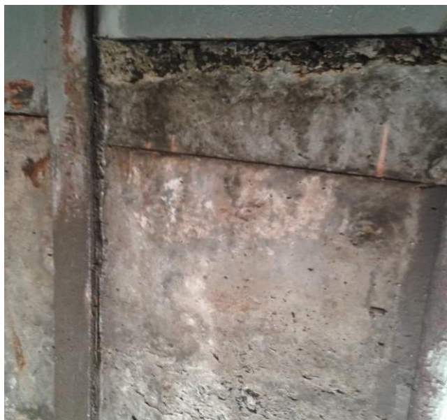
Obrázek 84: Nekvalitní beton pod místem vápenného výkvětu (foto autorka 4. 8. 2015)
