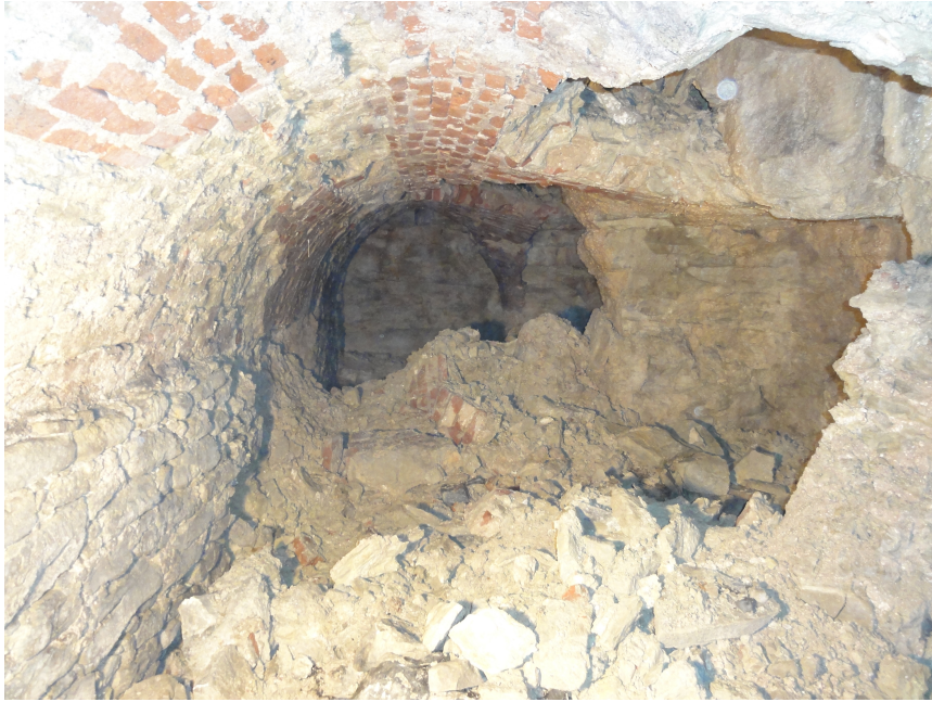
Obrázek 32: Levý trakt se spadaným stropem. [vlastní foto]
