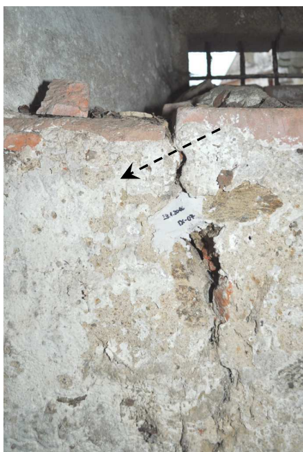
Obrázek 86: Suterén SZ bašty, při detailnějším pohledu je možné pozorovat šikmý posun části stěny (naznačený šipkou), trhlinka je opatřena sádrovým terčem, foto: autor, leden 2016
