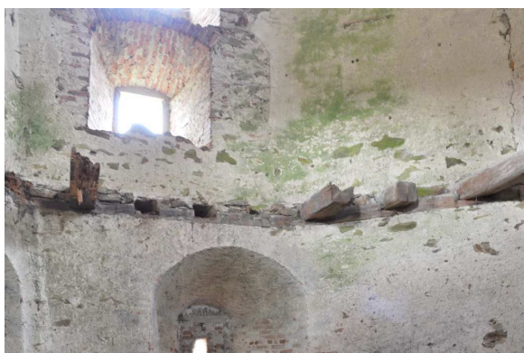
Obrázek 112: Degradace dřevěných prvků stropu přízemí, foto: autor, duben 2016
