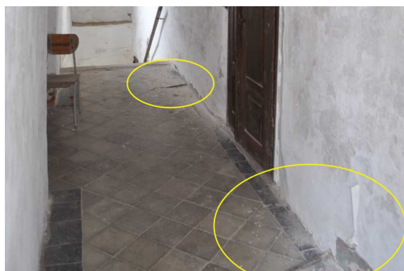
Obrázek 72: Viditelná ocelová táhla v úrovni podlahy chodbového traktu severního křídla, foto: autor, duben 2016
