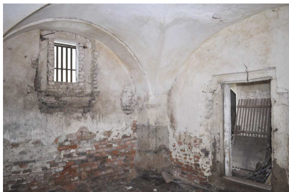
Obrázek 83: Odpadávající omítka u paty zdiva v přízemí severního křídla je důsledkem vzlínající vlhkosti, foto: autor, duben 2016
