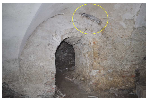
Obrázek 90: Suterén SZ bašty, v kroužku je označeno místo napadené dřevomorkou domácí, foto: autor, duben 2016
