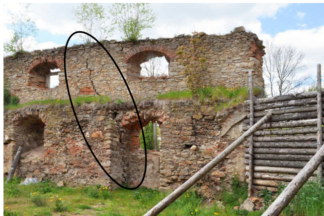
Obrázek 99: Vertikální trhlina u volného severního konce obvodové zdi, foto: autor, květen 2016
