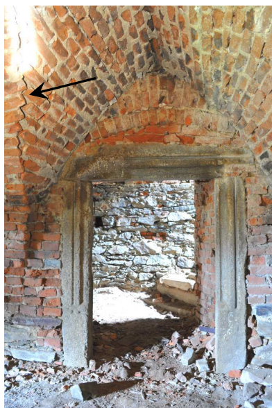
Obrázek 108: Šipka znázorňuje trhlinu v žeburu klenby, na snímku viditelné chybné osazení nadpraží vstupního portálu, foto: autor, duben 2016
