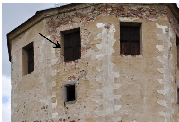
Obrázek 66: Snímek zachycuje odlupující se souvrství barokních omítek, viditelné je taktéž iluzivní armování nároží, šipka ukazuje „zalézání“ barokní omítky do špalet oken, foto: autor, květen 2016
