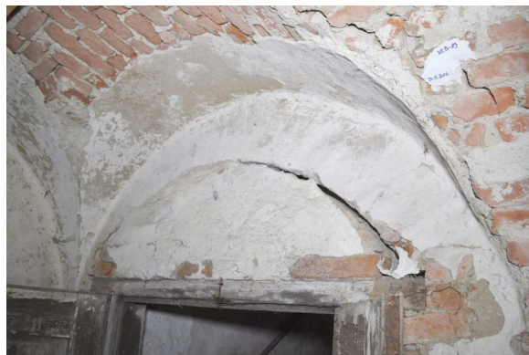
Obrázek 96: Odloučení výplňového zdiva od nosné konstrukce, foto: autor, duben 2016
