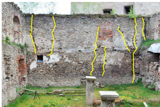
Obrázek 98: Jižní příčná stěna, viditelné trhliny po celé výšce stěny, šířka trhlín až několik cm, foto: autor, květen 2016
