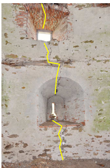
Obrázek 105: Statická trhlina, procházející přes celou výšku bašty, pohled z interiéru, foto: autor, duben 2016
