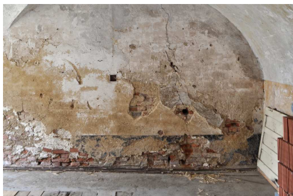
Obrázek 19: Barevnost a struktura omítek v přízemí severního křídla, foto: autor, duben 2016
