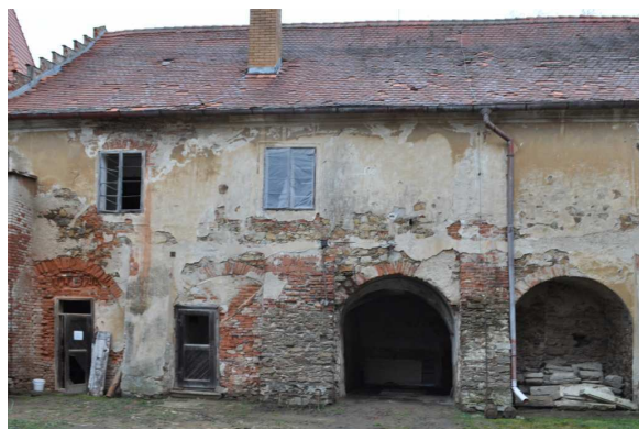
Obrázek 22: Silně narušená jižní fasáda, foto: autor, leden 2016
