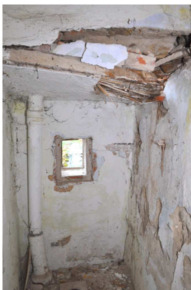
Obrázek 77: Totálně porušená část stropu nad místností 2.39b, havarijní stav, foto: autor, duben 2016
