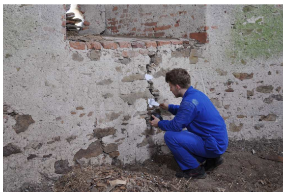
Obrázek 130: Aplikace sádrových terčů na význačné trhliny, leden 2016
