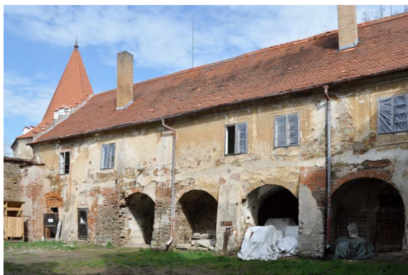
Obrázek 80: Celkový pohled na silně narušenou jižní fasádu severního křídla, foto: autor, duben 2016
