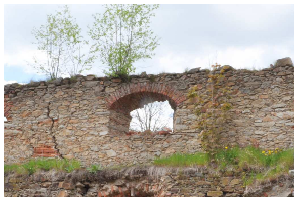
Obrázek 103: Bujná vegetace, vyrůstající z ústupku stěny, tak z její hlavní koruny, foto: autor, květen 2016
