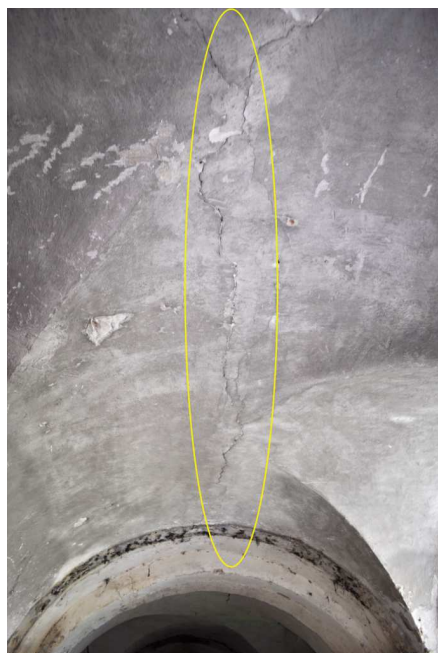
Obrázek 74: Trhlina procházející vrcholem valené klenby v přízemí, foto: autor, duben 2016
