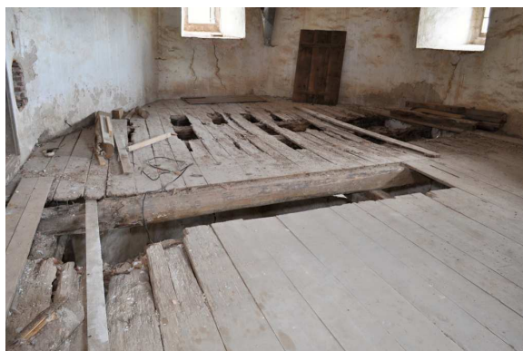
Obrázek 89: Ilustrativní snímek rozsahu poškození dřevěného stropu mezi přízemím a 1. patrem, foto: autor, duben 2016
