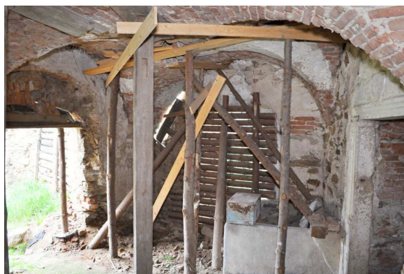
Obrázek 94: Chaotický způsob umístění podpůrných stojek v Z části přístavku, foto: autor, duben 2016
