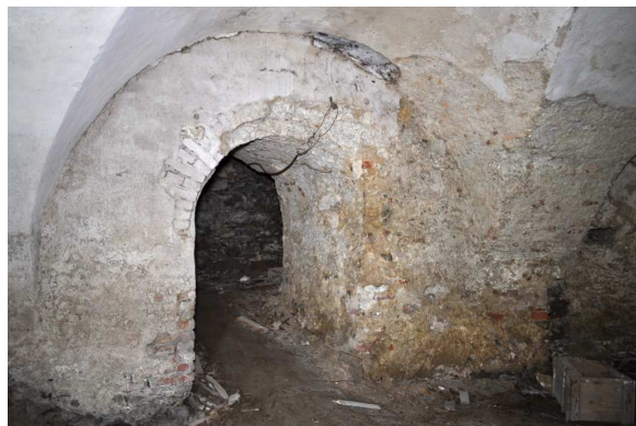
Obrázek 41: Vstup do suterénu, patrná rozmanitost povrchů v suterénu, silně degradované omítky s výkvěty solí vpravo, hrubozrnné omítky vlevo, hladké omítky kleneb nahoře, foto: autor, duben 2016
