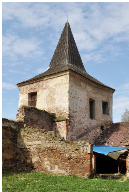
Obrázek 69: Pohled na JZ baštu z II. nádvoří, velmi dobře je patrná struktura střešního pláště, dřevěný šindel dodává střeše velmi hodnotnou plasticitu, foto: autor, duben 2016
