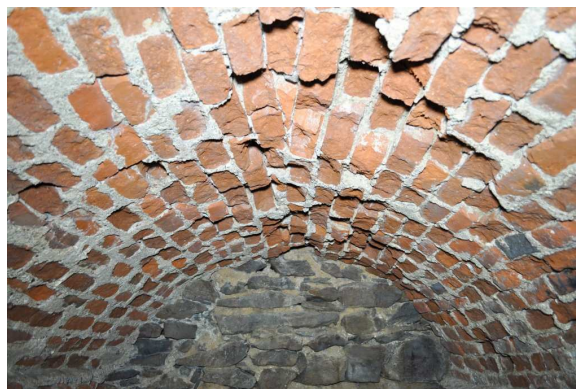
Obrázek 114: Degradované části cihel v klenbě nad schodišťovým prostorem, foto: autor, duben 2016
