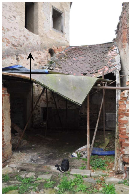
Obrázek 68: Havarijní stav pultového zastřešení oblasti, kryjící vstup do bašty, na stěně bašty viditelný otisk původní polohy zastřešení, foto: autor, duben 2016
