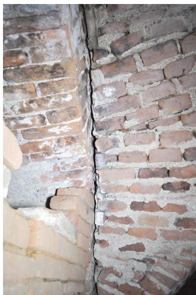
Obrázek 107: Separace čel klenebních polí od obvodové stěny, foto: autor, duben 2016
