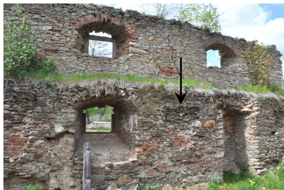
Obrázek 56: Ilustrace okenních otvorů v západní obvodové zdi, šipka naznačuje polohu kapsy pro uložení klenby, foto: autor, květen 2016
