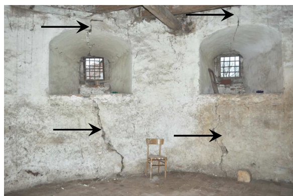
Obrázek 85: Široké trhliny v přízemí SZ bašty, šipky označují jejich polohu, foto: autor, leden 2016
