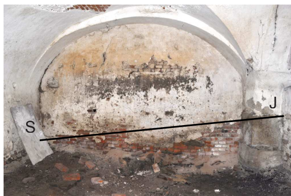
Obrázek 84: Na přičné stěně spojující severní a jižní obvodovou stěnu je patrný nárůst výšky vzlínající vlhkosti směrem k II. nádvoří (srovnávací čára), taktéž je na stěně patrná velká plocha výkvětů solných roztoků, foto: autor, srpen 2015
