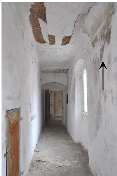
Obrázek 76: Část degradovaného podhledu v chodbovém traktu 1. patra, narušený podhled bezprostředně ohrožuje prostor pod sebou, šipka poukazuje na výskyt plísní, foto: autor, duben 2016
