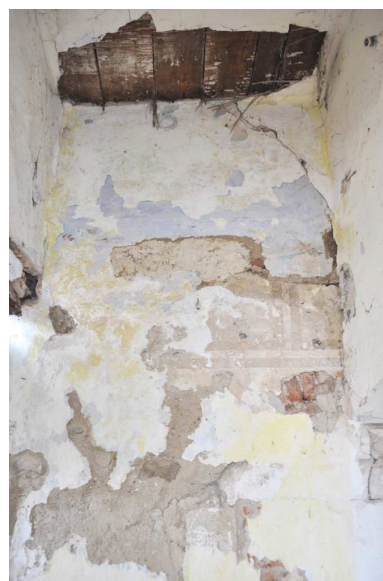
Obrázek 78: Zatékání způsobuje kromě degradace stropních konstrukcí i narušení omítkových vrstev, na snímku příklad z místnosti 2.39b, foto: autor, květen 2016
