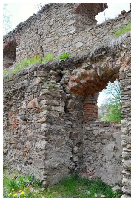
Obrázek 100: Detailnější pohled na trhlinu, foto: autor, květen 2016
