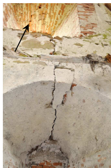
Obrázek 106: Detail potřhaného záklenku okna, šipka naznačuje trhlinu v barokním záklenku okna, foto: autor, duben 2016
