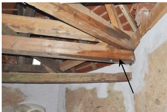
Obrázek 87: Na obnovených prvcích krovu jsou viditelné stopy po zatečení srážkové vody, foto: autor, říjen 2015
