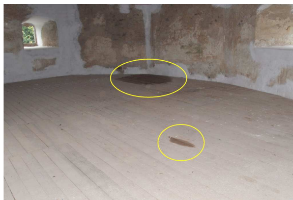
Obrázek 88: Stopy po zatečení střešním pláštěm na dřevěné podlaze 3. patra SZ bašty, foto: autor, říjen 2015
