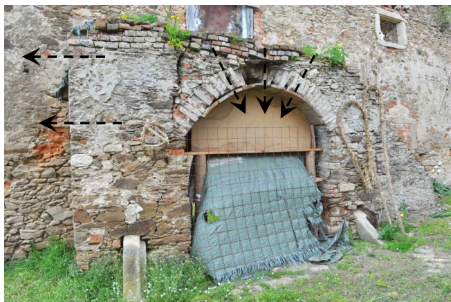
Obrázek 101: Silně narušené exteriérové schodiště, šipky znázorňují předpokládané směry deformací, na snímku je dobře vidět dřevěné podbednění klenby, foto: autor, květen 2016
