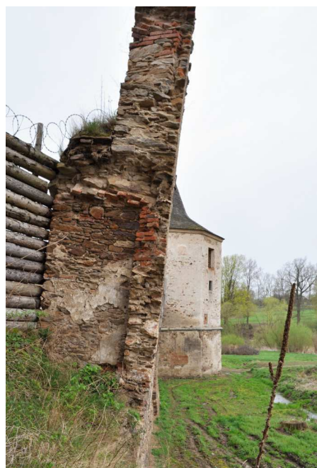
Obrázek 97: Náklon západní obvodové zdi bývalé konírny, foto: autor, duben 2016
