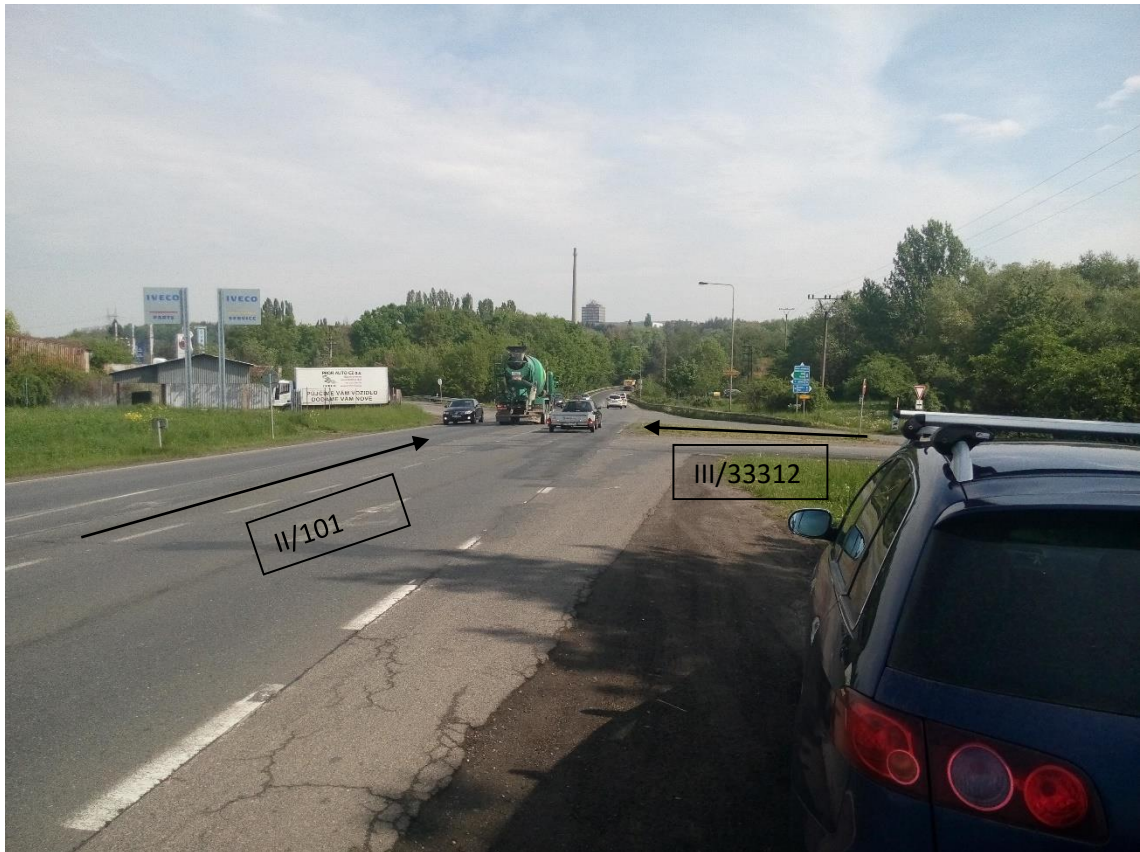
Obrázek 51 Stav vodorovného dopravního značení a povrchu vozovky
