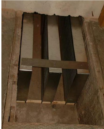
Obr. 2-7 Kanál pro odvod vzduchu z bezodrazové místnosti s umístěnými kazetovými tlumiči hluku [L5]
