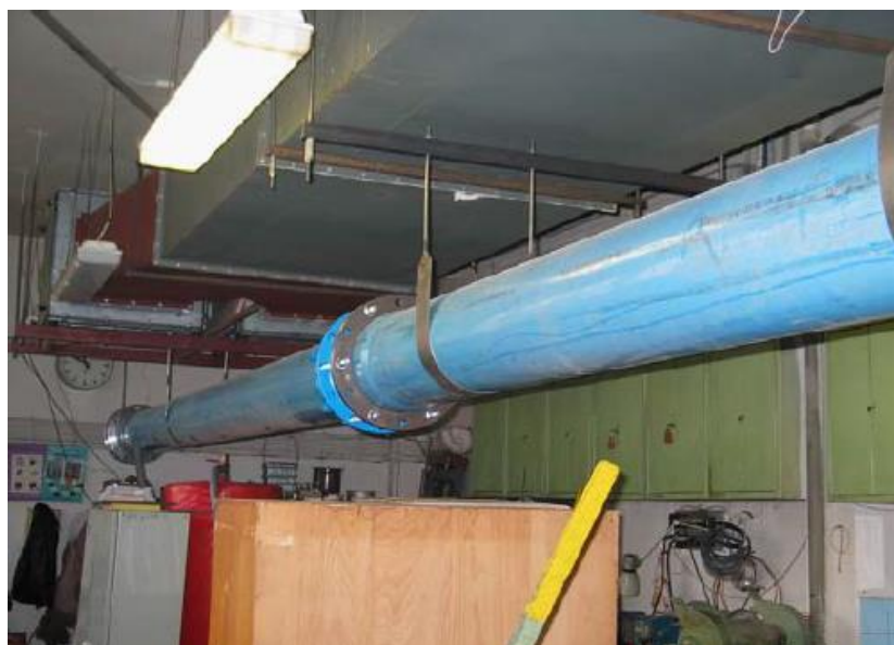
Obr. 2-5 Hlavní část potrubí měřící experimentální trati s tlumiči hluku [L5]
