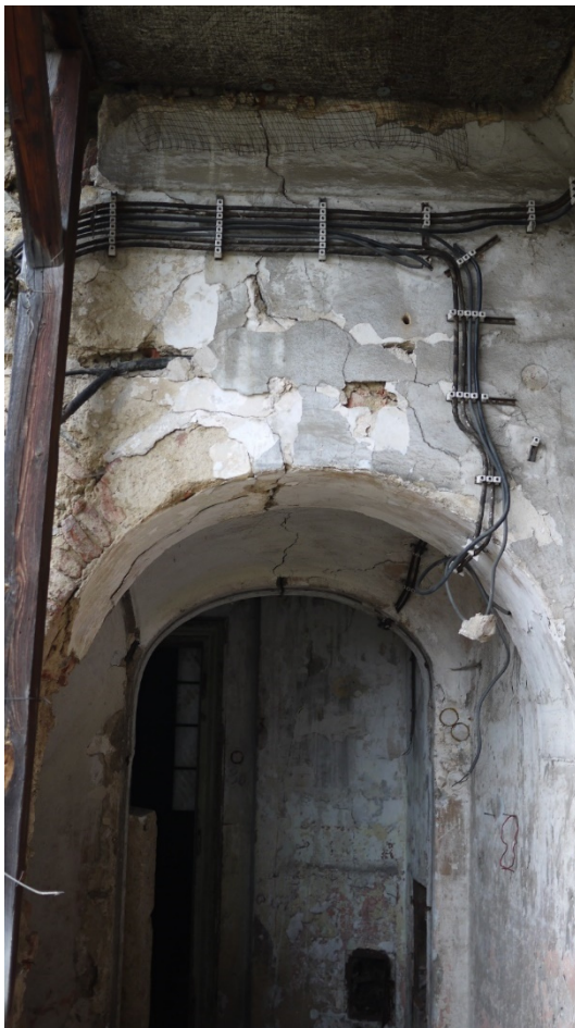
Obrázek 2.2.19 Trhlina oddělující věž od zbytku křídla
