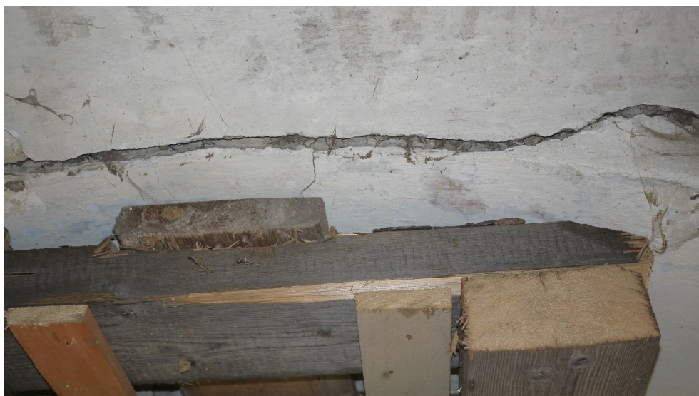
Obrázek 2.2.26 Trhlina mezi valným obloukem a trámovým stropem, který je na něj uložen - věž
