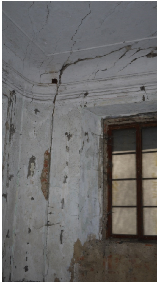
Obrázek 2.2.18 Trhlina nasvědčující odklon štítu
