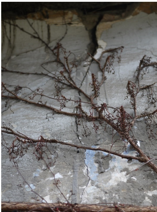
Obrázek 2.2.20 Trhlina nad prostupem ve zdi východního křídla v 2.NP směrem do dvora
