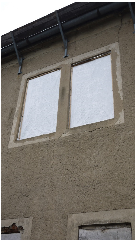
Obrázek 2.2.17 Trhliny na západní fasádě
