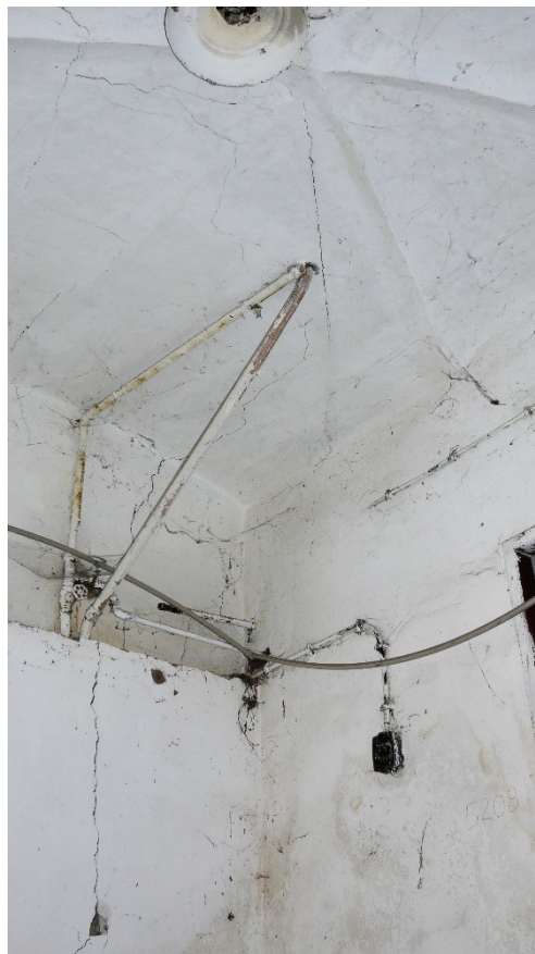
Obrázek 2.2.27 Trhlina procházející na skrz místnosti
