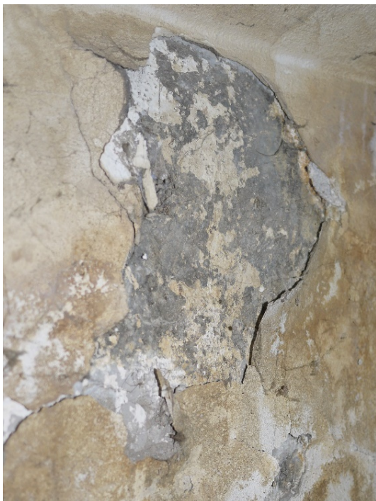
Obrázek 2.2.13 Degradovaná omítka vlivem vlhkosti
