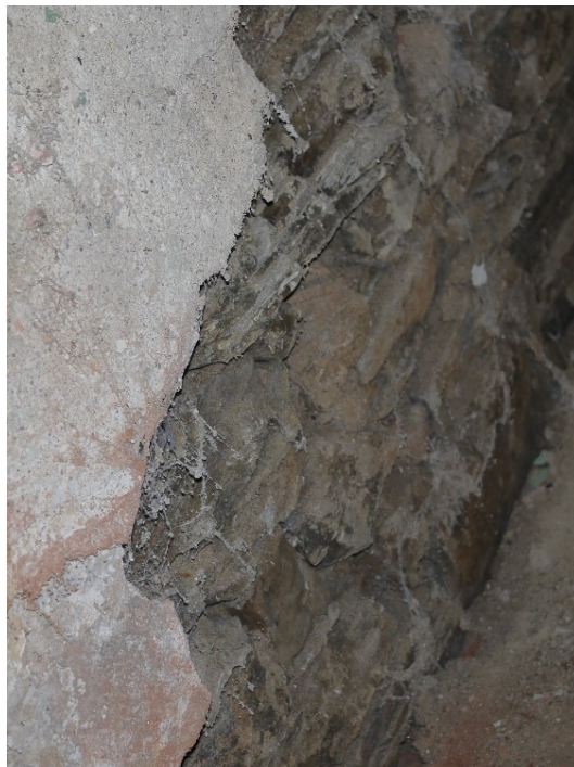
Obrázek 2.2.12 Degradovaná omítka vlivem vlhkosti
