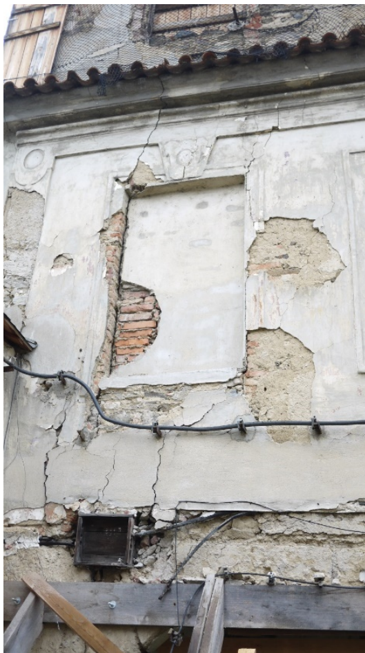
Obrázek 2.2.16 Trhliny na jižní fasádě věže
