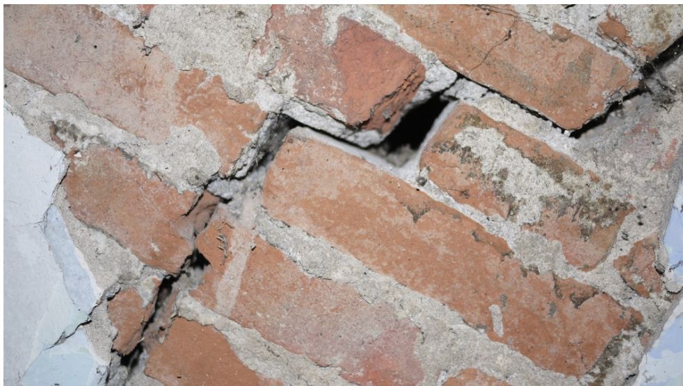
Obrázek 2.2.32 Detail trhliny z obr. 2.2.23
