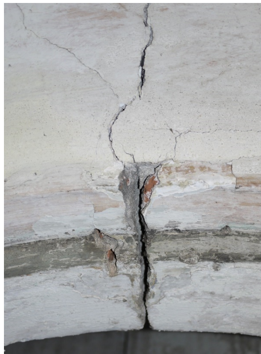
Obrázek 2.2.21 Detail trhliny z obr. 2.2.13
