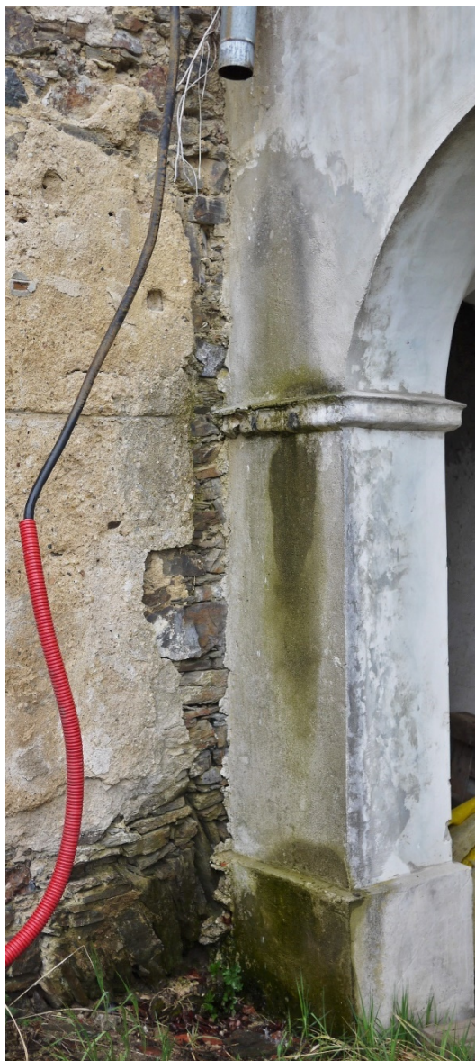
Obrázek 2.2.10 Degradované zdivo vinou absence okapního svodu
