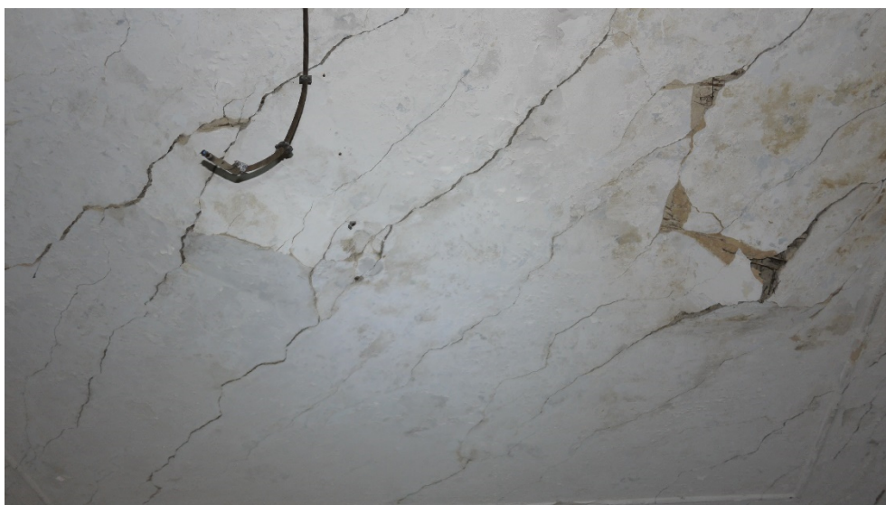
Obrázek 2.2.24 Trhliny na podhledu trámového stropu
