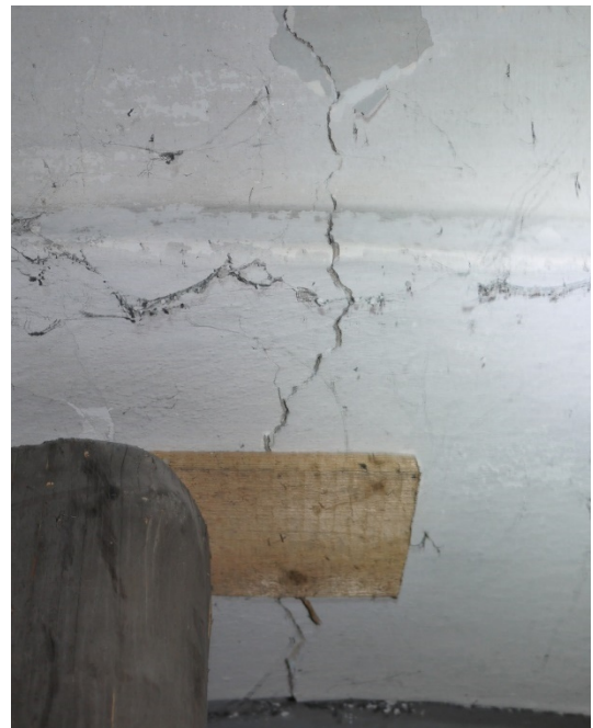
Obrázek 2.2.30 Trhlina v koruně valného pasu
