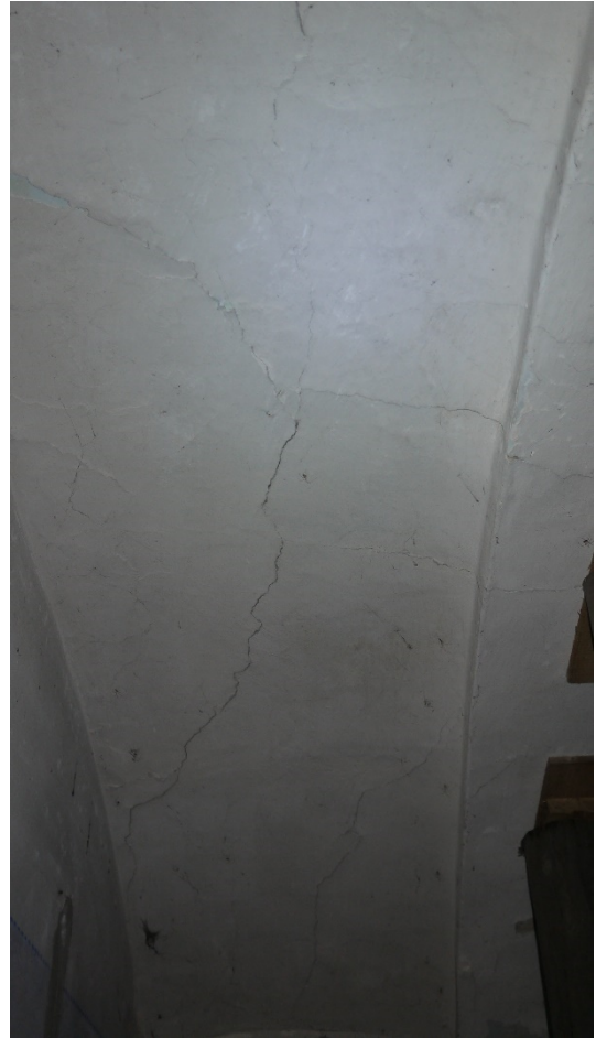
Obrázek 2.2.28 Trhliny uprostřed plackové klenby
