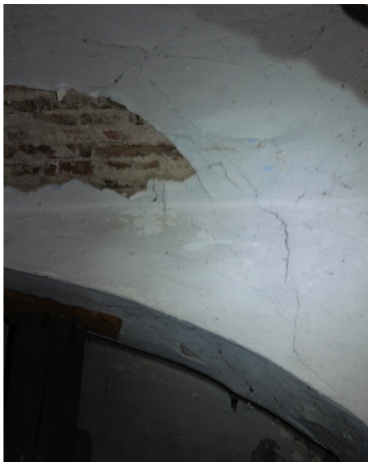
Obrázek 2.2.31 Trhlina v patě valného pasu
