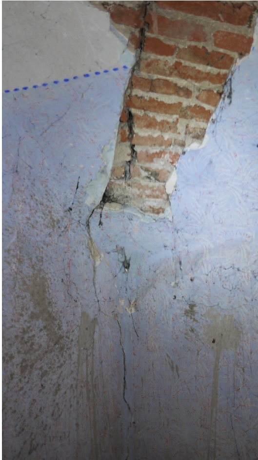
Obrázek 2.2.29 Trhlina táhnoucí se plackovou klenbou od jedné podpory k druhé
